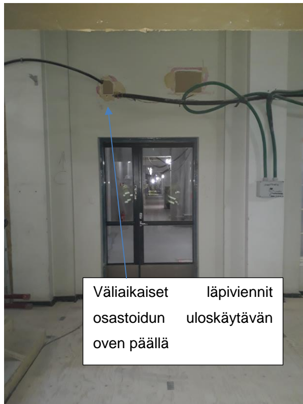
Kuva 22. Työmaa-aikainen palokatko työmaasähköjä varten. Kuva: Pekka Ronkainen
