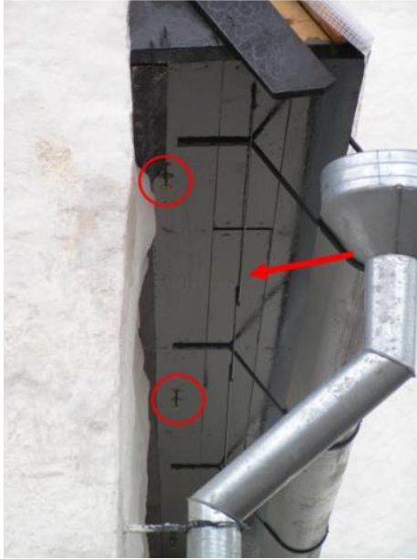
Kuva 16. Paloilmoittimen lämpökaapeli kiertää ränneissä ja syöksykouruissa antamassa hälytystiedon ja ohjaamassa osaltaan räystässprinklerin laukaisua. Kuva: IUPL arkisto /23/
