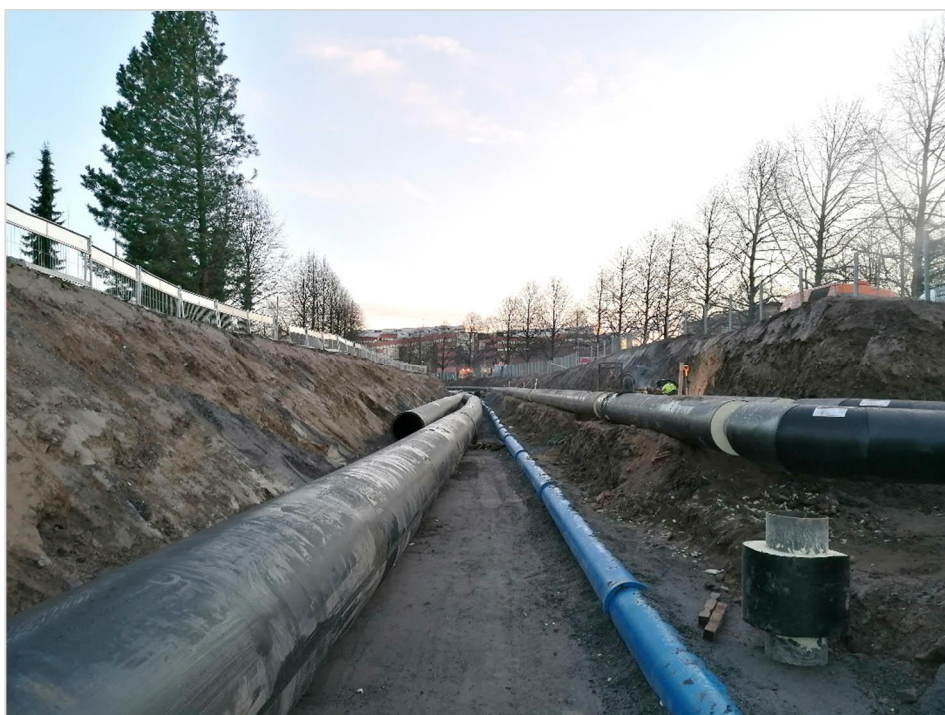
Kuva 2. Kaivanto infratyömaalla, johon asennettiin muun muassa jäteveden paineviemärit, vesilinjat, kaukolämpö- ja -kylmä sekä sähkökaapeli (kuva: Salmela, 2020).
