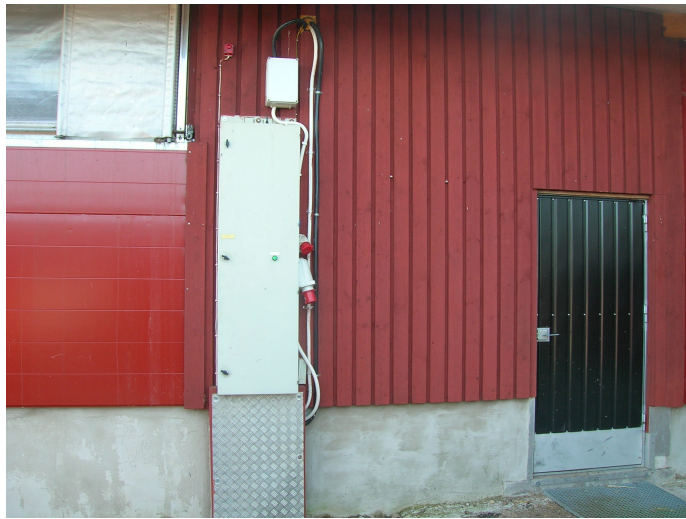
KUVA 9 Mikäli sähkölaitteissa on häiriö ja virtaa pääsee vuotamaan, niin sähköpääkeskuksella syttyy punainen merkkivalo ja summeri alkaa soida. (Mäkelä 2009)
