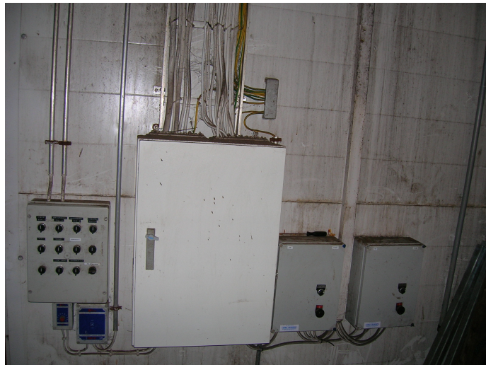
KUVA 7 Sähkökeskukset kuuluvat mahdollisiin riskikohteisiin tulipalon syttymisen kannalta. (Mäkelä 2009)
