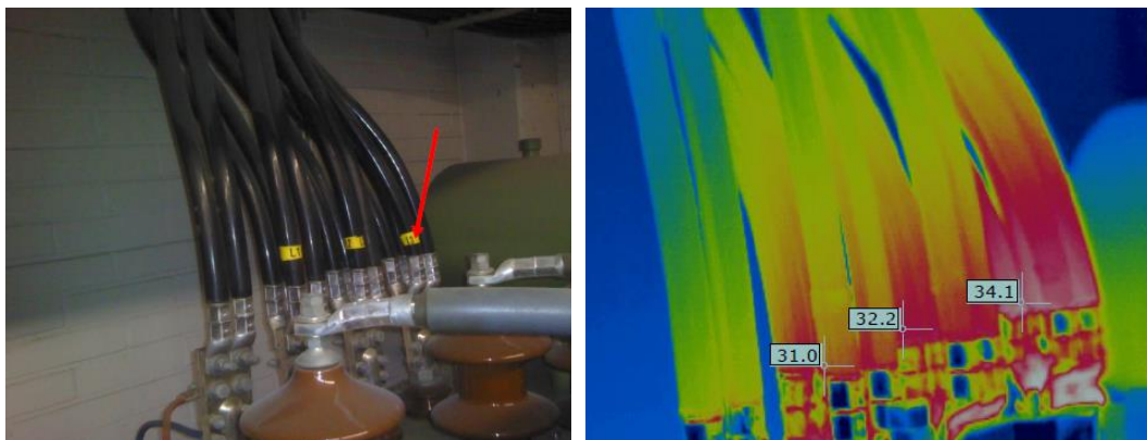
Kuva 8 muuntajan toisiopuolen lämpökuva
