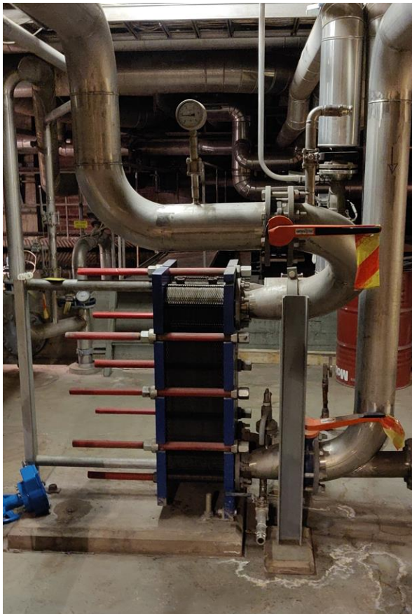
Kuva 4. Mekaanisesti puhdistetun veden lämmityksen lämmönsiirrin
