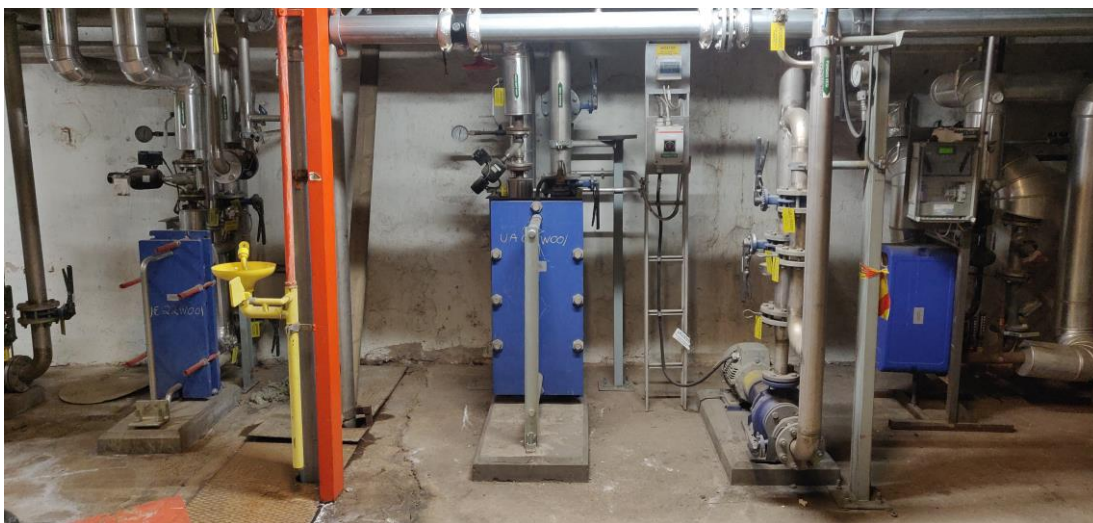
Kuva 3. Kemiallisesti puhdistetun veden lämmönsiirrin, lipeän laimennusveden lämmönsiirrin ja kiinteistölämmönsiirrin
