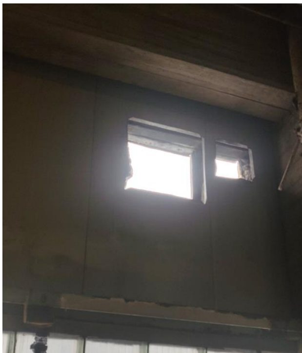
Kuva 8. Purkutöistä jääneitä reikiä rakennuksen ulkoseinässä
