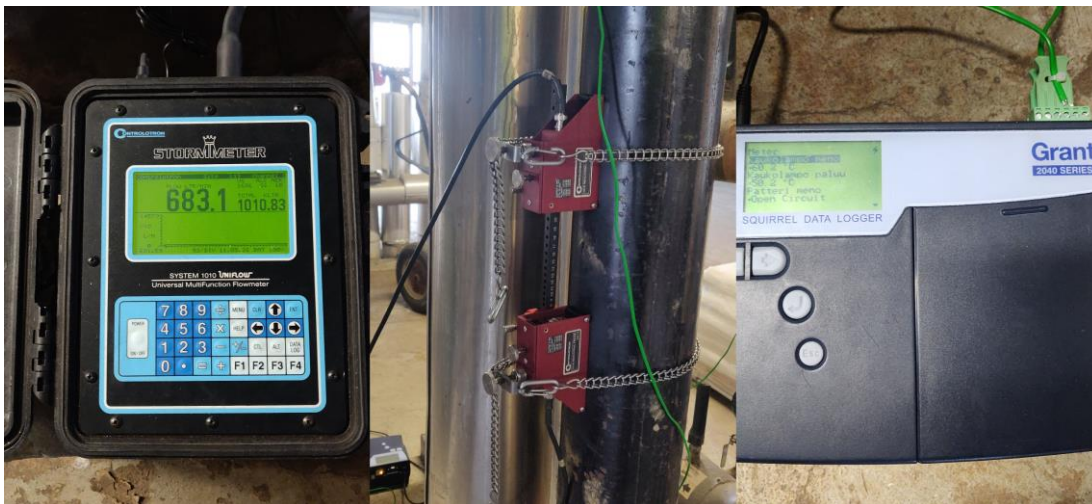
Kuva 7. CONTROLOTRON 1010P/WP ultraäänivirtausmittari, mittausanturit sekä Grant Squirrel dataloggeri
