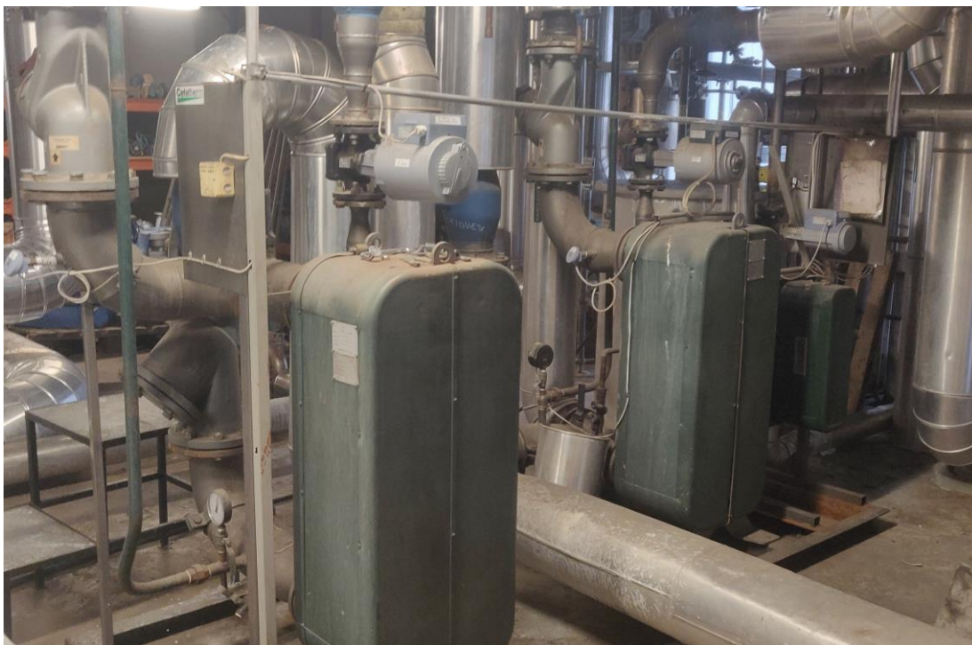
Kuva 1. Kattilarakennuksien lämmityksen lämmönsiirtimet ja käyttöveden lämmönsiirrin
