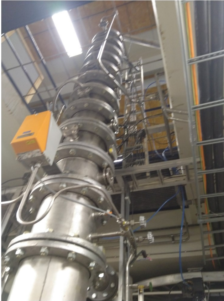
KUVA 8. Systemitekniiikan laitoksen tislaukolonni
