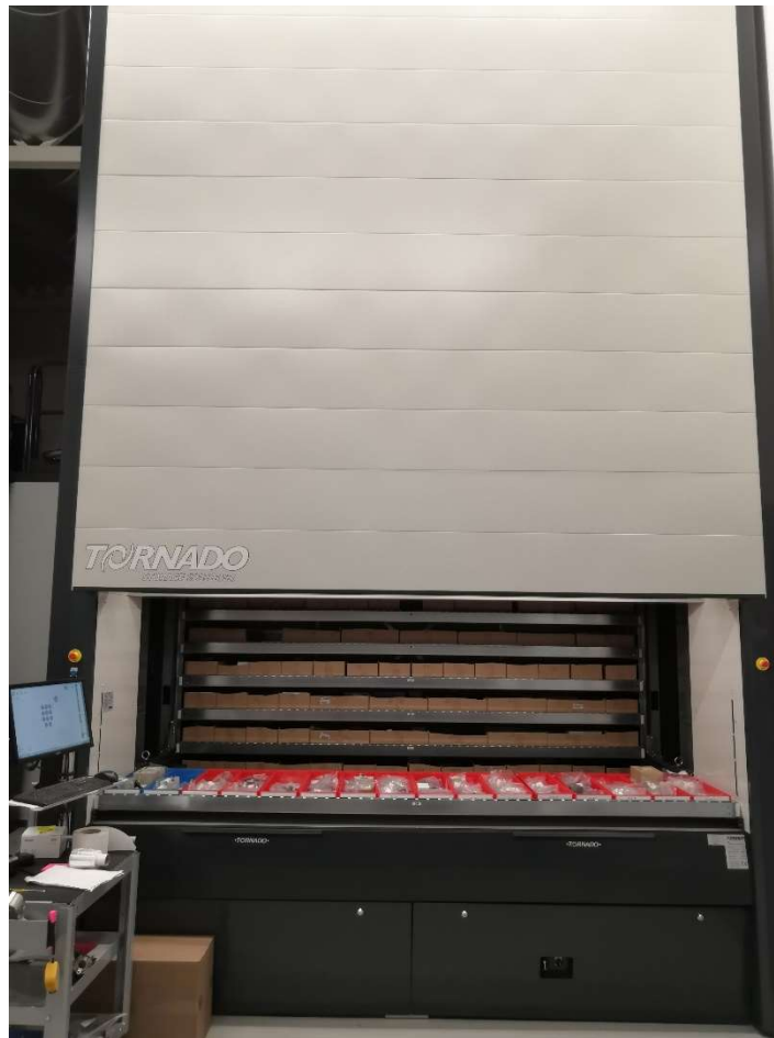
Kuva 2. Tornado-varastoautomaatti Levorannan Autoliikkeessä.
