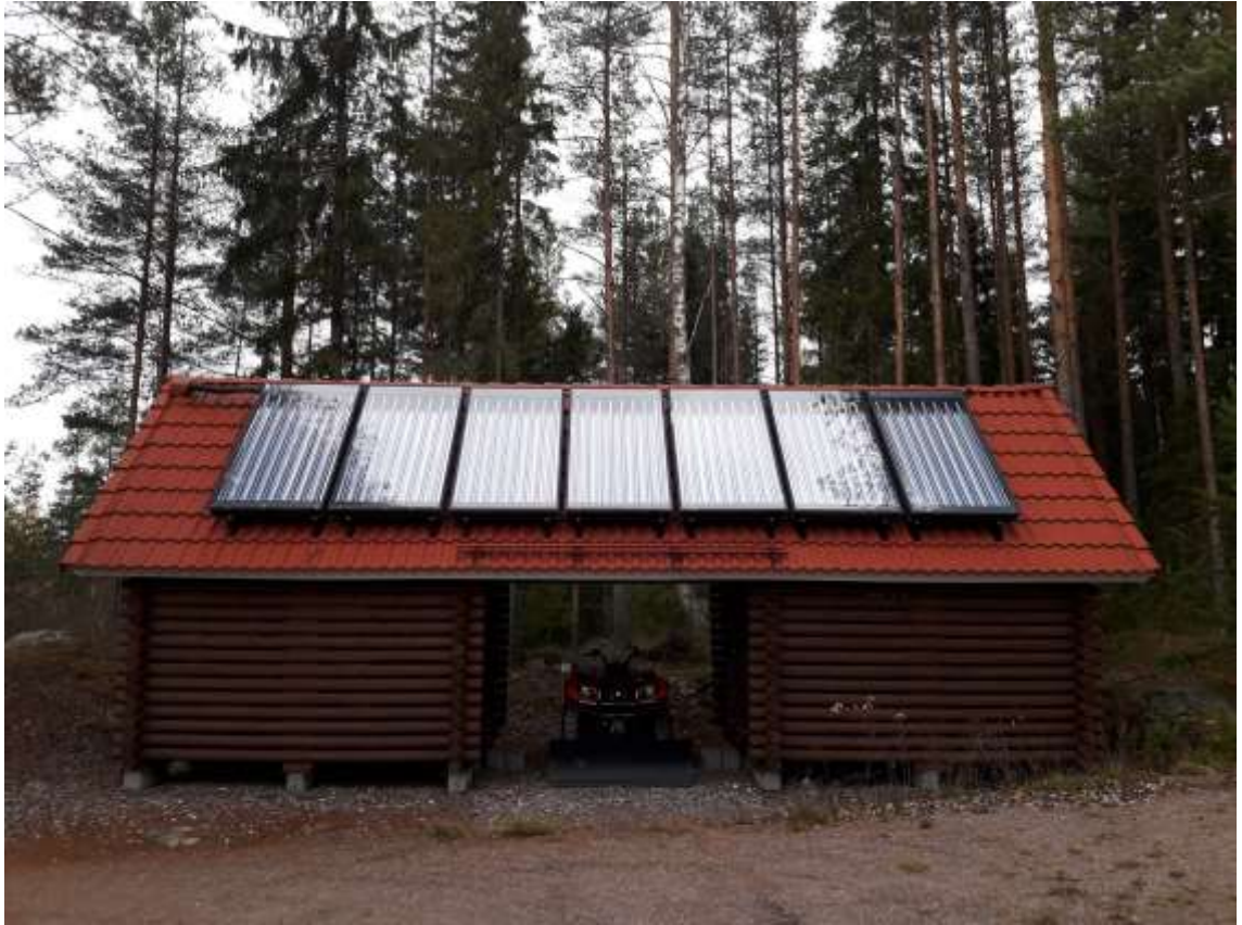
Kuva 6. Putkiaurinkokeräimiä suojalasin alla.
