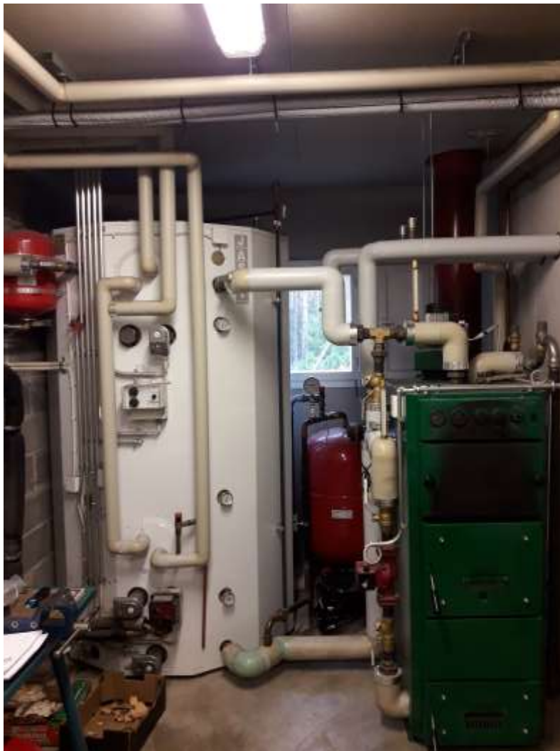
Kuva 5. Hybridijärjestelmän lämminvesivaraaja ja puukattila.
