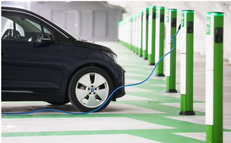
Kuva 18. Sähköautojen latauspisteitä kauppakeskus REDI:ssä (IGL-Technologies, 2019)
