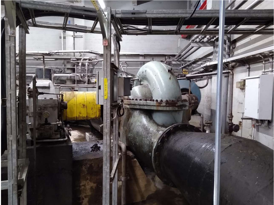
Kuva 4. Yksi vesilaitoksen pumpuista sekä pumpulle menevä vesiputkilinja
