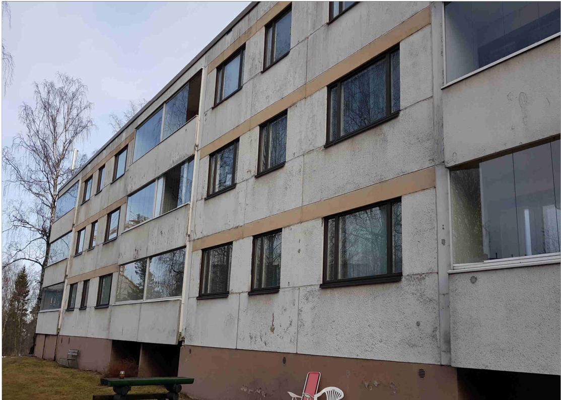
Kuva 16. Rakennuksen lounaissivulla havaittiin julkisivupinnoilla maalikalvon vaurioita. Kuva: Arja Pekkala 2019.
