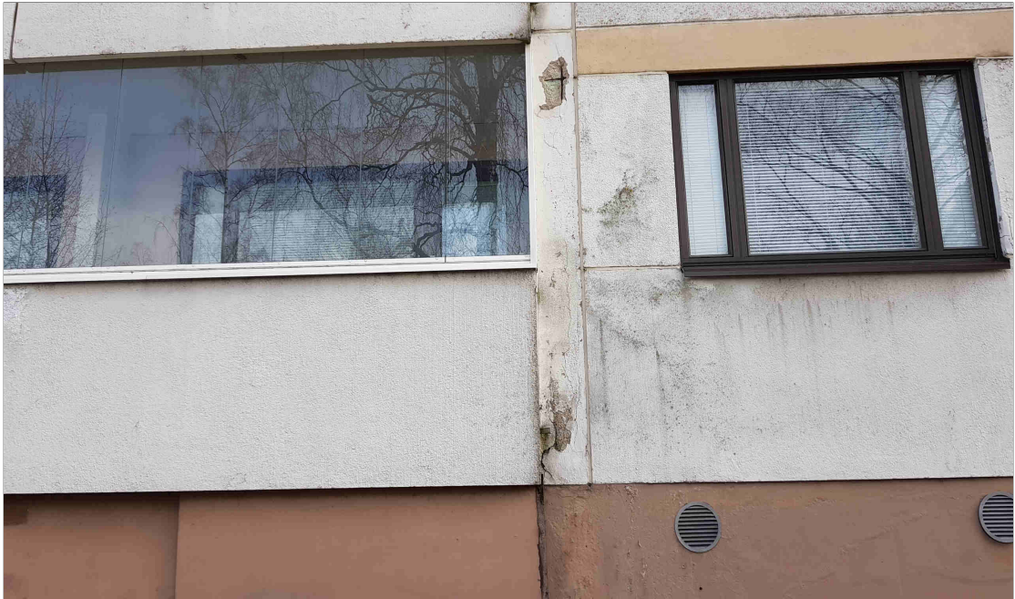
Kuva 19. Lämpimien pieliseinien otsapinnoissa teräskorroosion ja rapautumisen aiheuttamaa vaurioitumista. Kuva: Arja Pekkala 2019.
