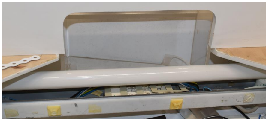
Kuva 48. Vanha valaisin, jonka rungosta puuttuu suojakotelon kansi
