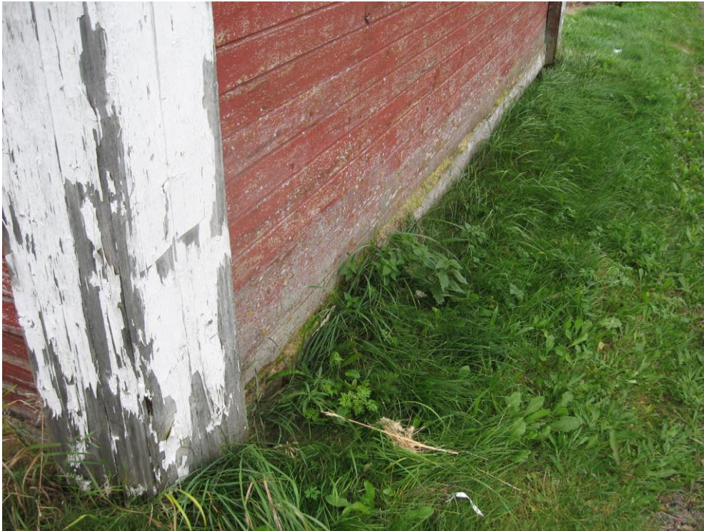
KUVA 3. Perustukset ovat painuneet pohjoispuolella rakennusta
