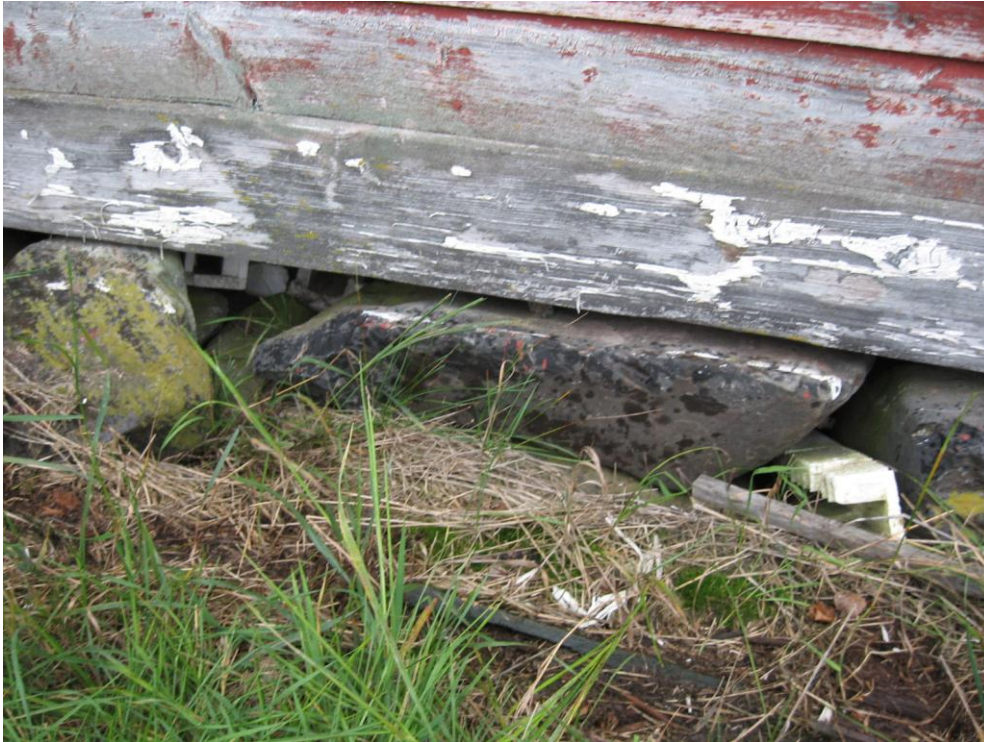
KUVA 4. Perustuksien vaurioita länsipuolella rakennusta
