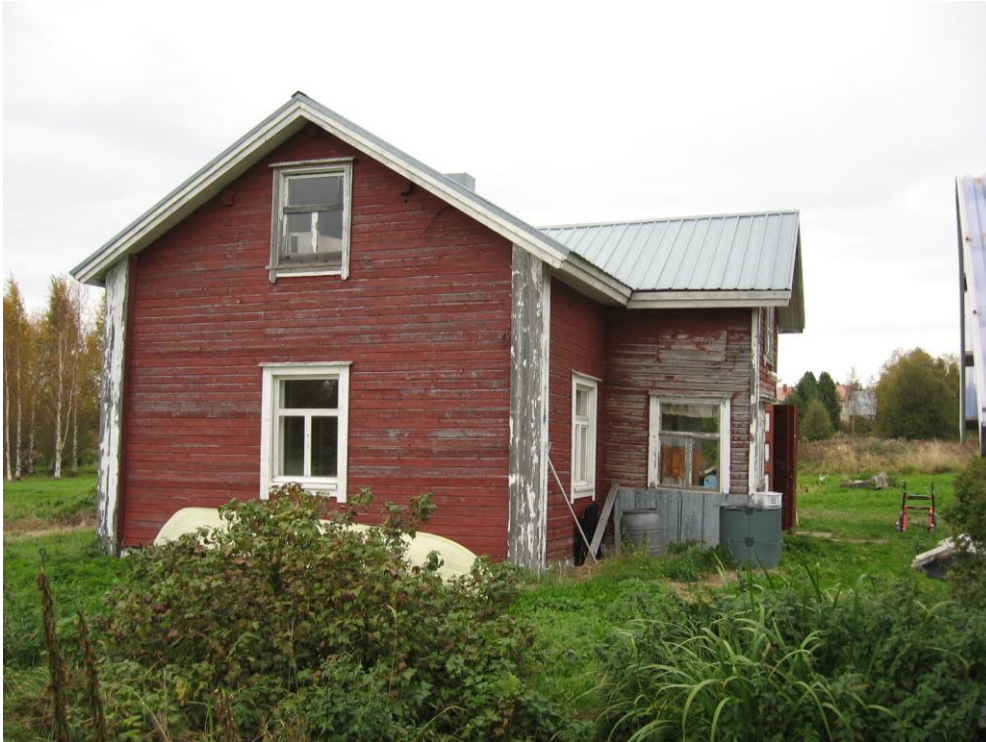
KUVA 11. Kuisti on etureunastaan painunut
