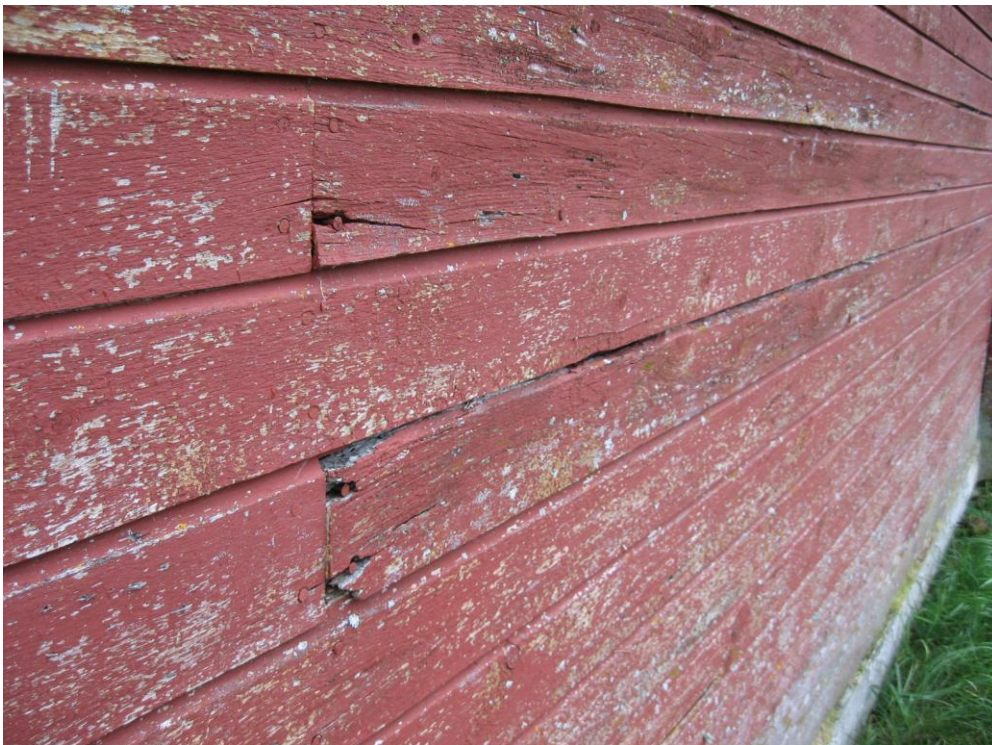
KUVA 8. Vaurioita pohjoispuolen ulkoverhouksessa
