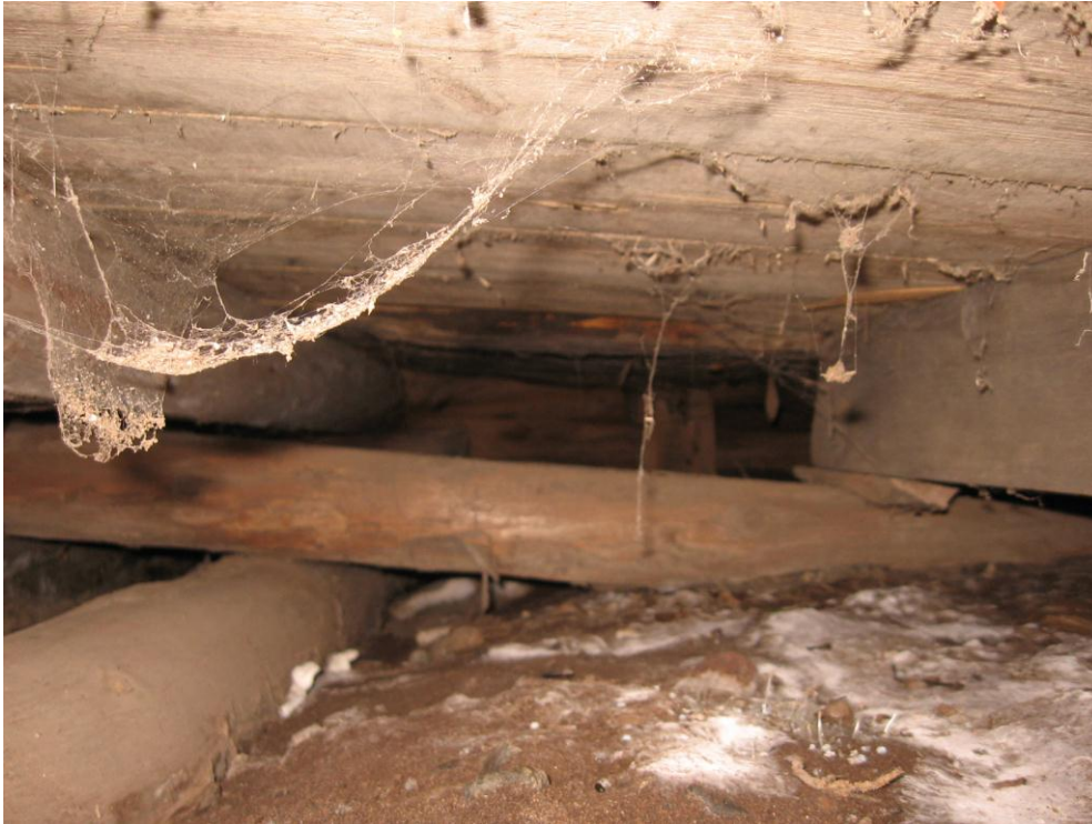
KUVA 12. Kuistin rakenteita ja maan pinnassa olevaa sienirihmasto
