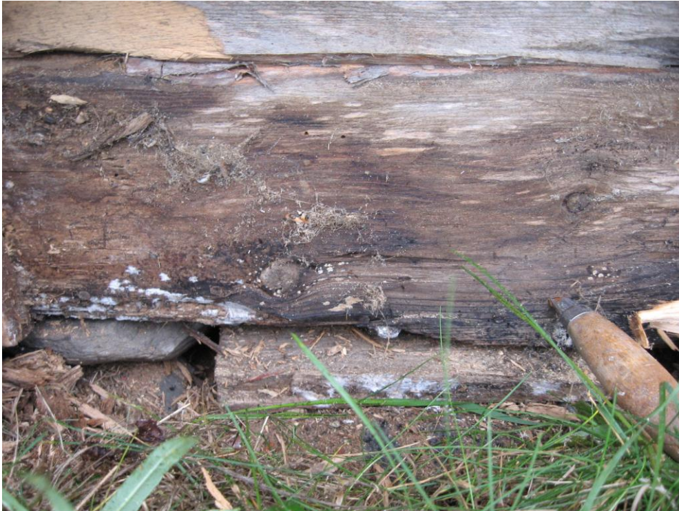
KUVA 6. Lahovaurioita alimmassa hirressä rakennuksen pohjoispuolella
