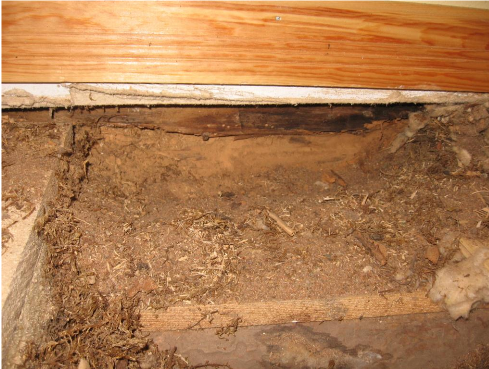
KUVA 7. Lahovaurioita hirsiseinässä alapohjan kohdalla
