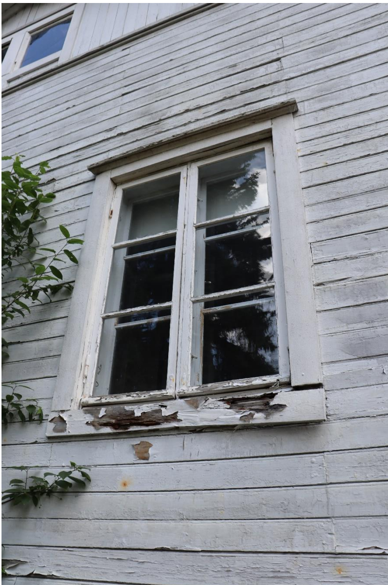
Kuva 11. Villa Kovalefin ikkunan kunto vierailukäynnillä (Nousiainen 2020c)
