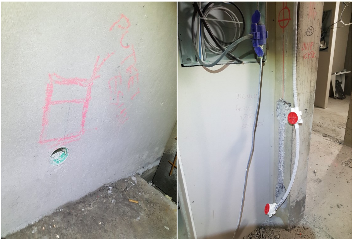
Kuva 6 Tukkeutunut sähköputki, joka joudutaan avaamaan ja korjaamaan työmaalla [KH]
