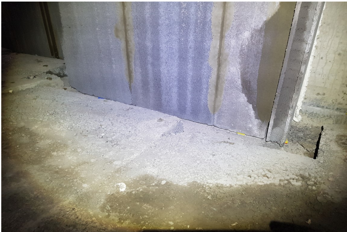
Kuva 19 Ako-seinän virheellisesti tehty nurkkaliitos. [KH]
