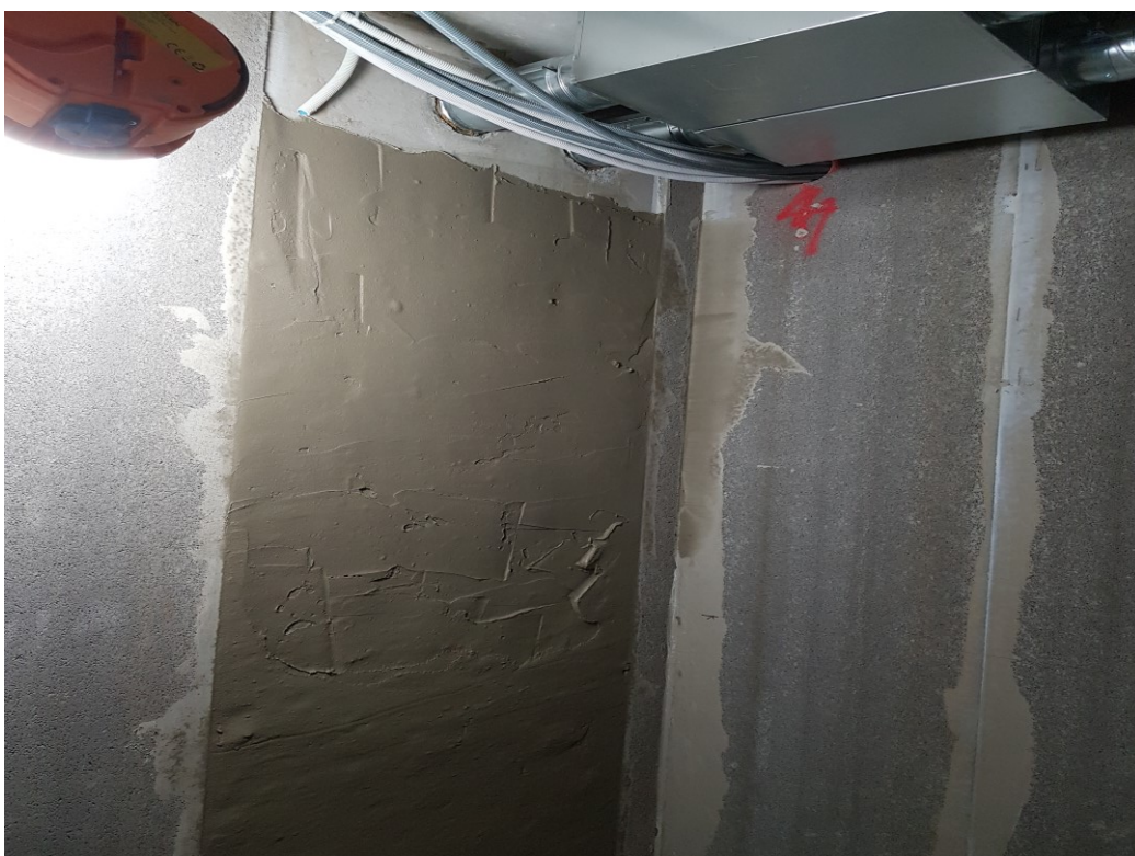
Kuva 23 Virheellisesti mitattu kosteantilan ako-seinän linjaus tekniikkahormiin nähden. [KH]
