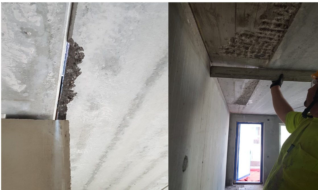
Kuva 14 Sivuttaisen siirron yhteydessä lohjennut ontelolaatan reuna. [KH]
