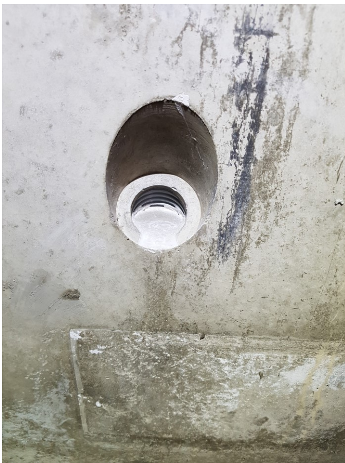
Kuva 9 Asennustyöhön kuuluva paikkaus tekemättä. [KH]
