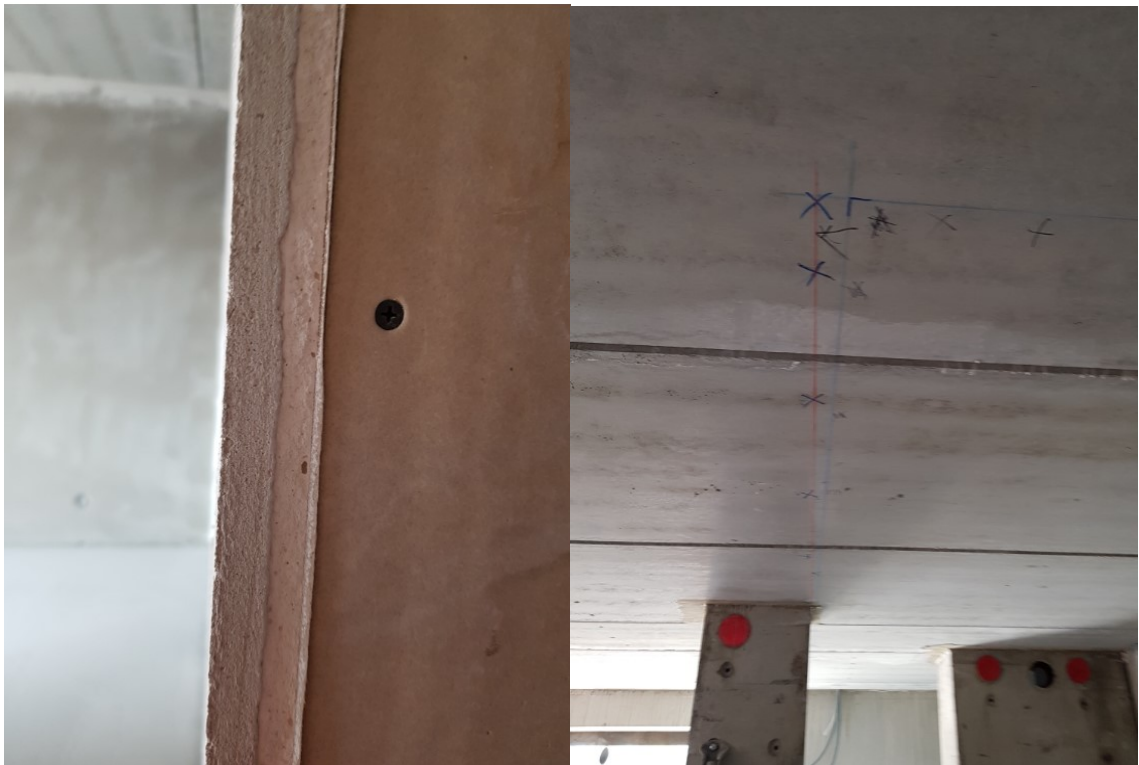
Kuva 21 Vinoon mitattu ja rakennettu väliseinä, joka on jouduttu oikaisemaan suoraksi. [KH]
