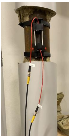
Kuva 17. Kaukolämmön paluuv veden virtausmittaus.
