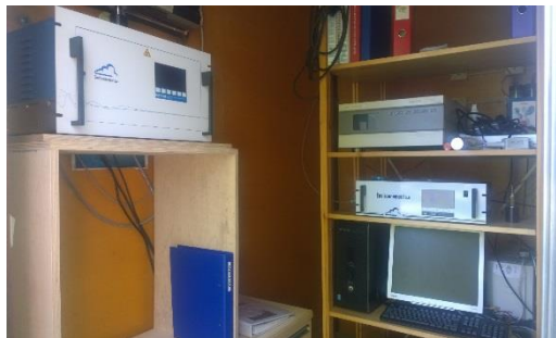
Kuva 6. Seinäjoen mittausaseman laitteisto.
