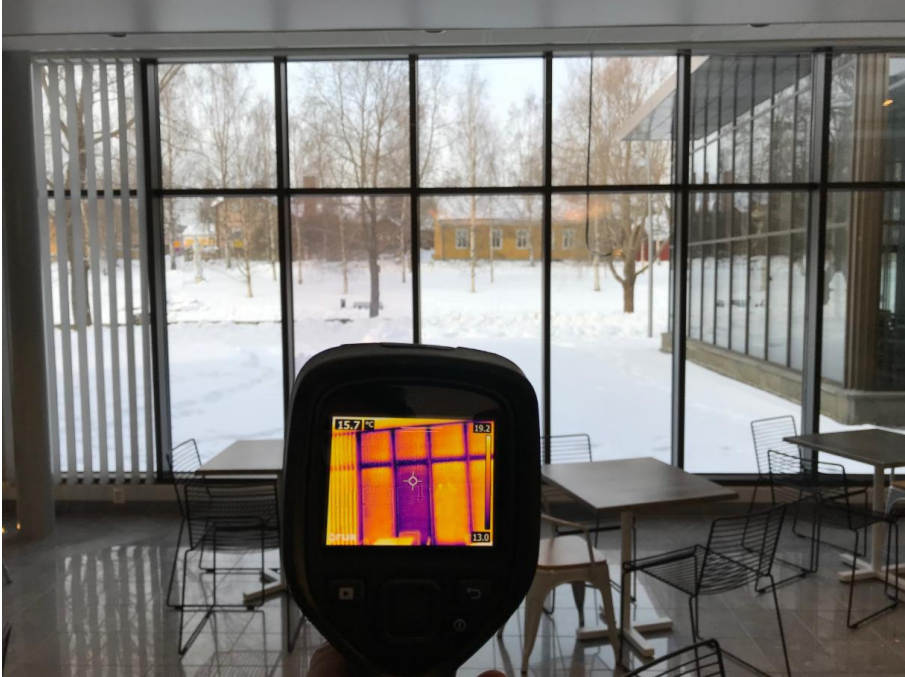
KUVA 10. Vaurioitunut lasielementti, Kokkolan kaupungintalo (Saukko 2018)
