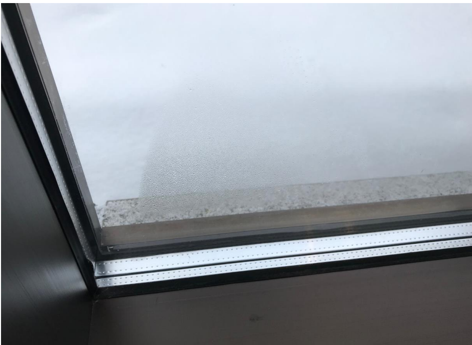
KUVA 11. Vaurioitunut lasielementti, lähikuva, Kokkolan kaupungintalo (Saukko 2018)
