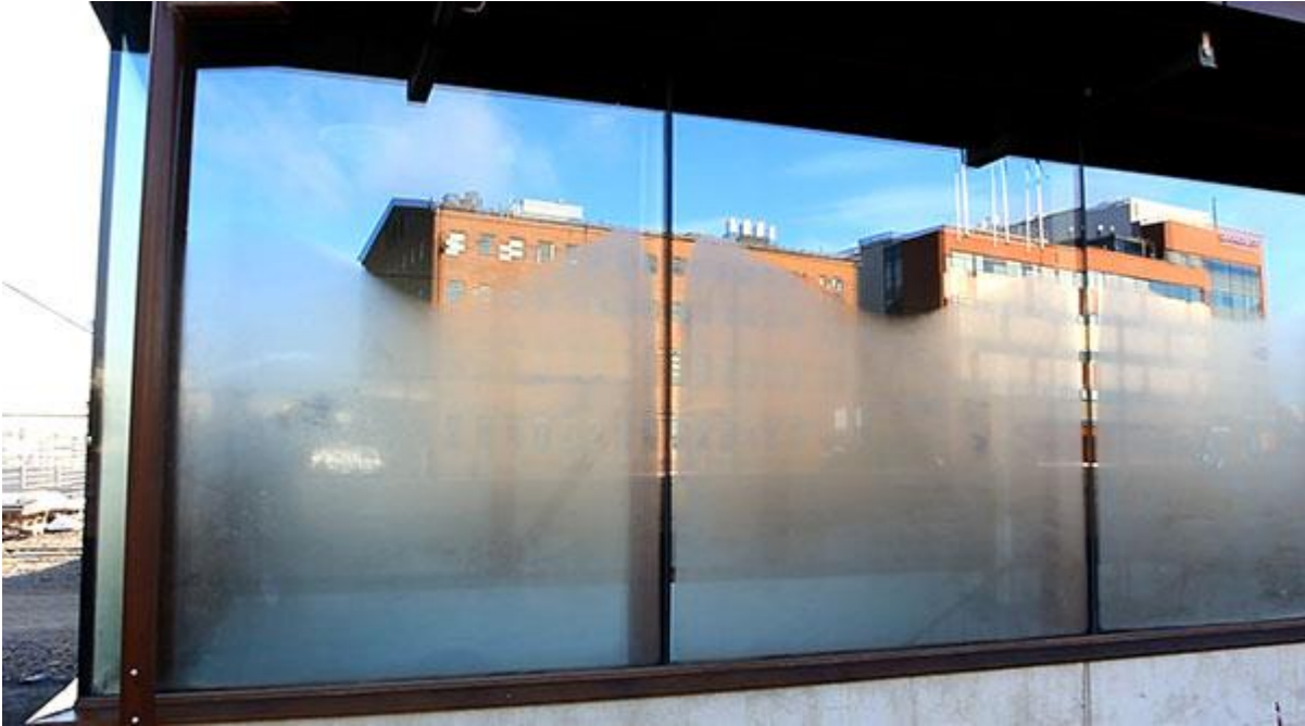
KUVA 9. Laselementin ulkopinnan huurtuminen (Ikkunawiki)
