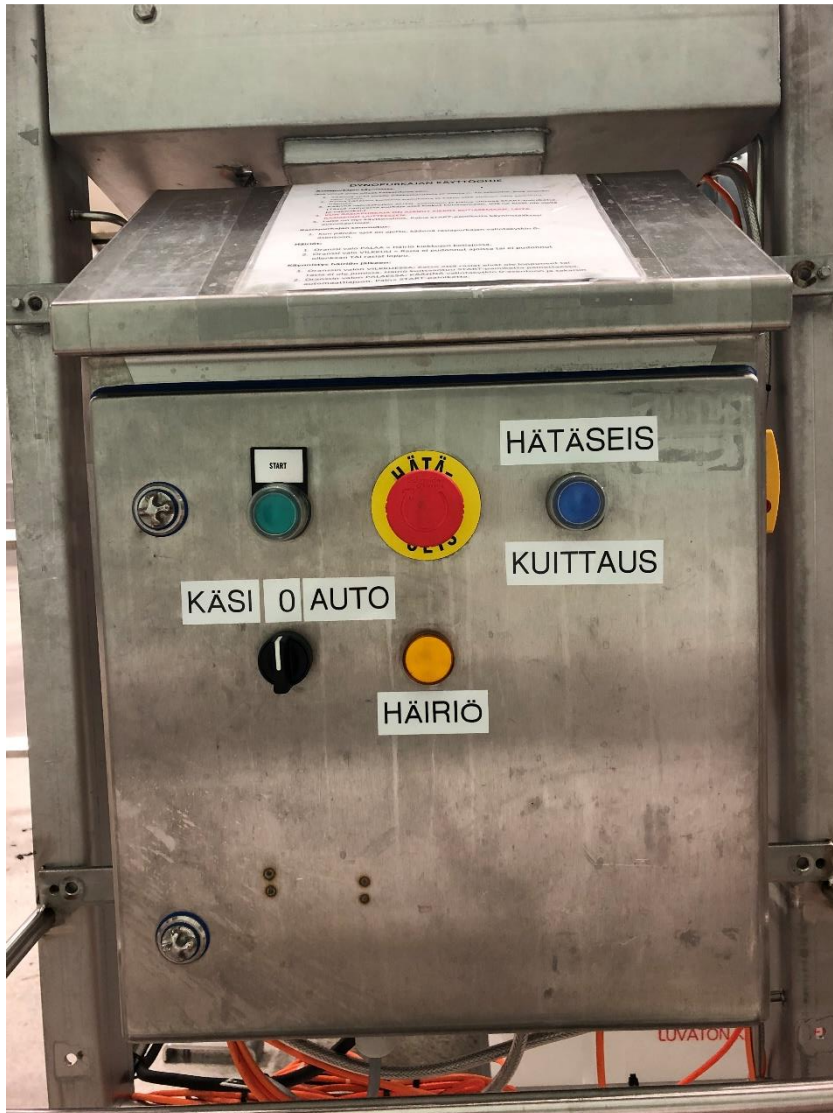
Kuva 9. Uusi ohjauskeskus asennettuna paikoilleen.
