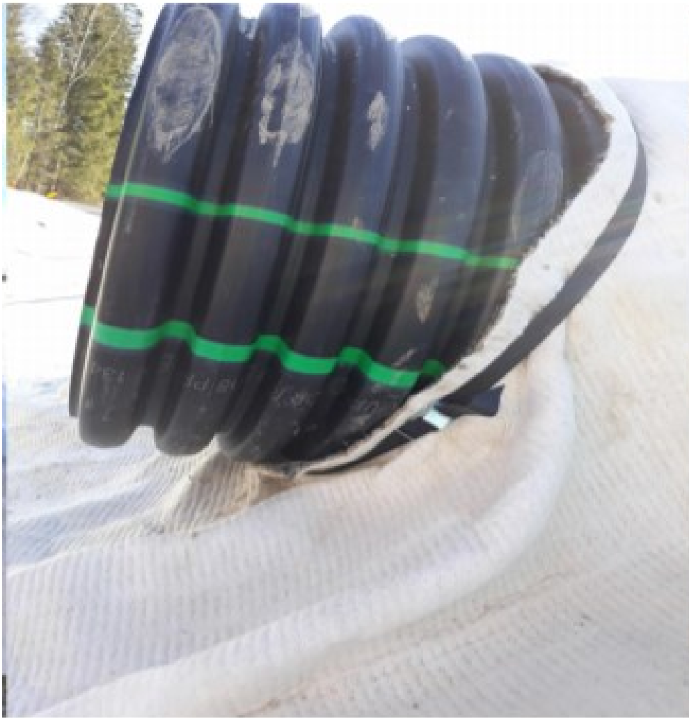
Kuva 12. Alitusrummun läpivienti luiskassa.
