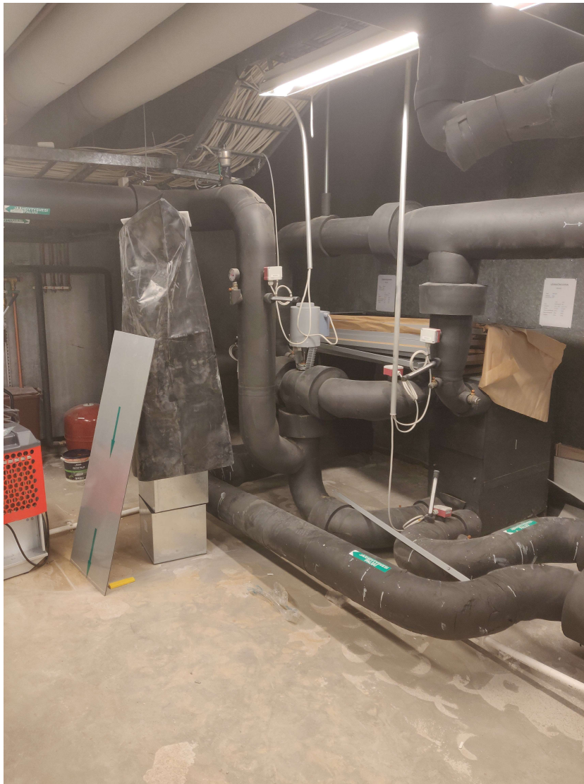
Kuva 9. Vedenjäähdytyskone 1:n putkistot olivat suurimmillaan kokoa DN150.
