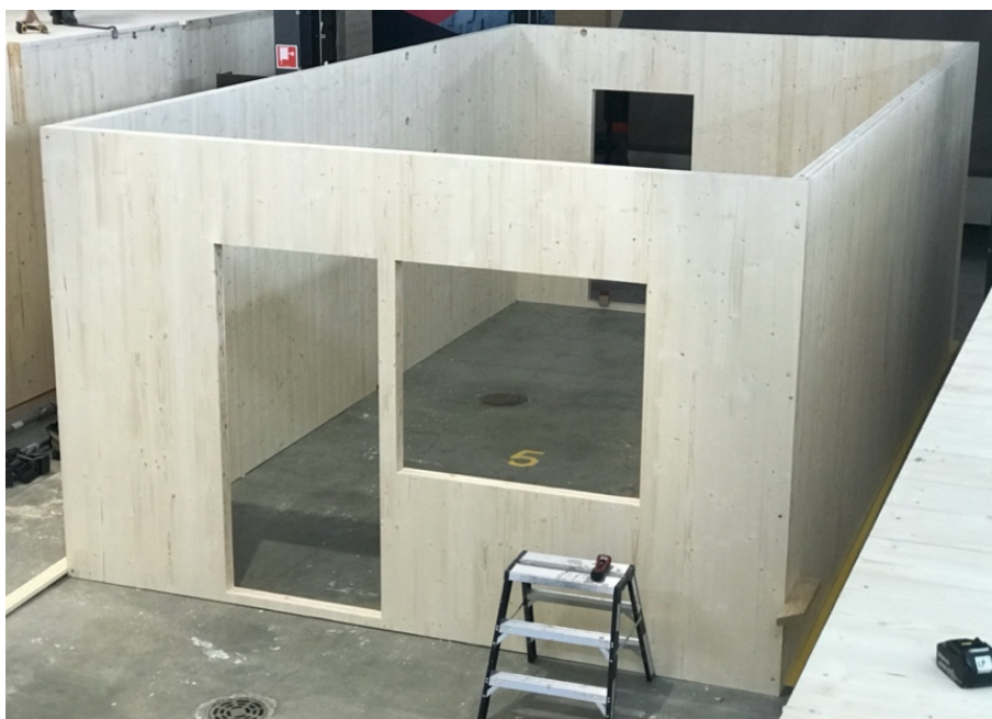
Kuva 3. Tilaelementtejä voidaan valmistaa sisätiloissa, jonka jälkeen niiden asennustyömaalla valmiina yksikköinä on nopeaa
