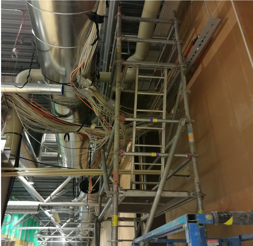
Kuva 7 Talotekniikkaa ja telineitä. Oma kuva
