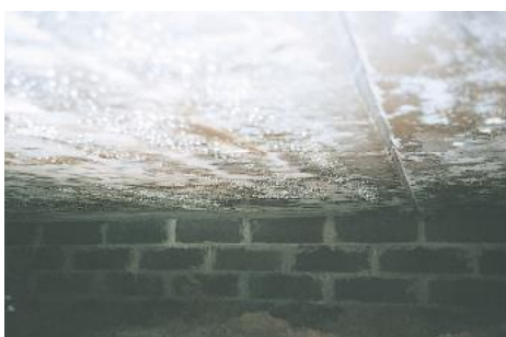
Kuva 1. Kondenssivettä ryömintätilassa (RT 05-10710 1999).
