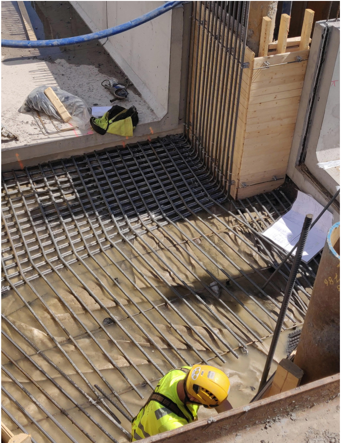
Kuva 10. Kanaalin Jääkairankujan ja Kalasatamankadun risteys tehtiin paikalla valaen. Kuvassa rauditustyö meneillään. Tätä kaivantoa pidettiin kuivana pontein ja kolmella suurella pumpulla.
