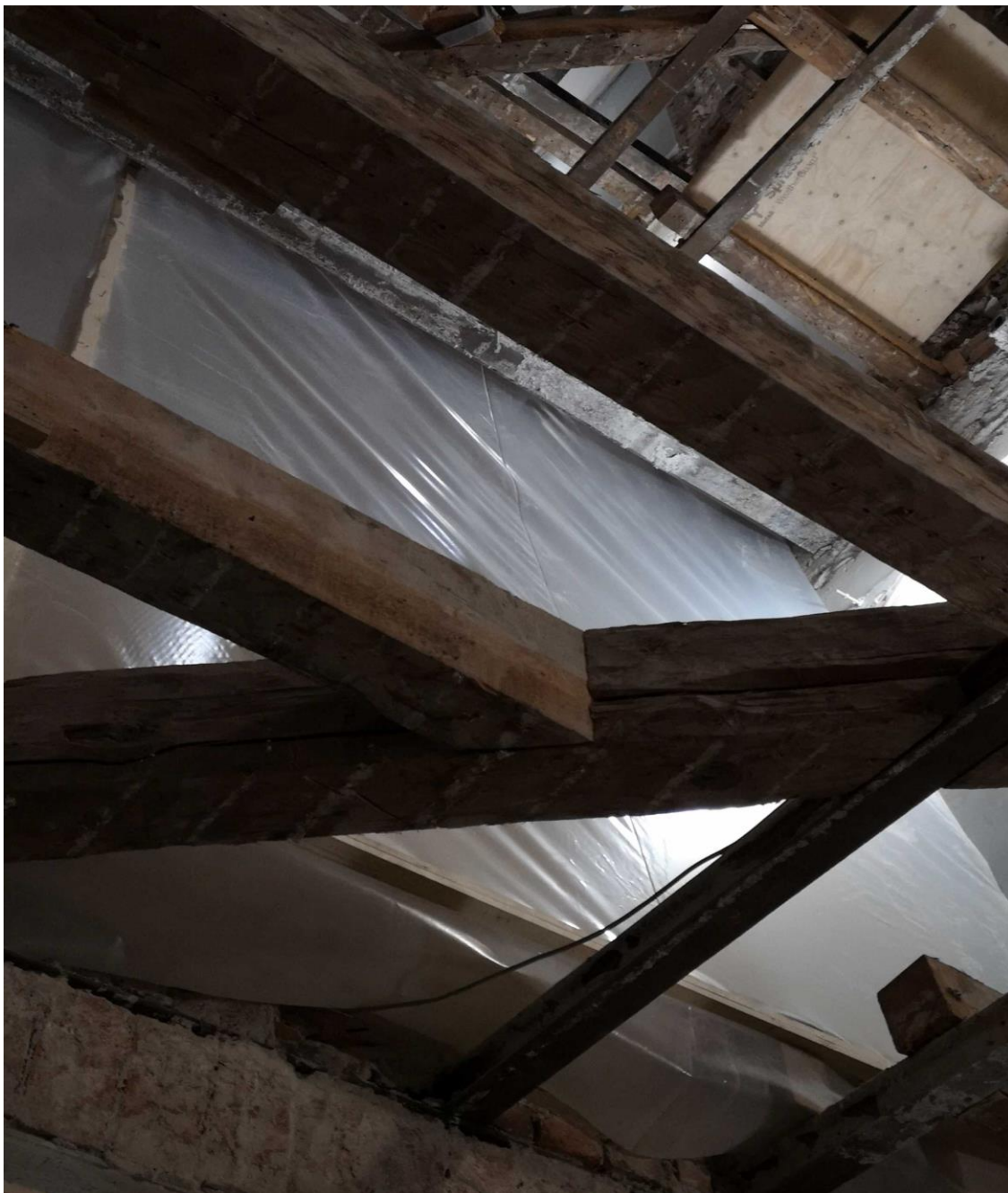
Kuva 13. Vanhat rataiskot sekä purettu tiiliholvaus.
