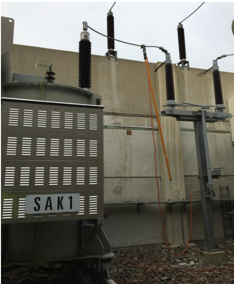
KUVA 41. Työn aikaisia kytkentöjä. Maadoitusta ei tule koskaan tehdä väärälle puolelle erotinta, tähtipisteen jännite voi olla useita kilovoltteja. Maadoitusköyden pää on oltava aina kiinni maadoituspisteessä ennen lisäystä tai poistoa.
