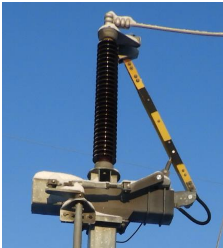
KUVA 16. Tähtipisteen maadoituserotin. Tähtipiste on maadoitettuna suoraan maahan, koska maadoitusveitsi on ylhäällä. (24.)
