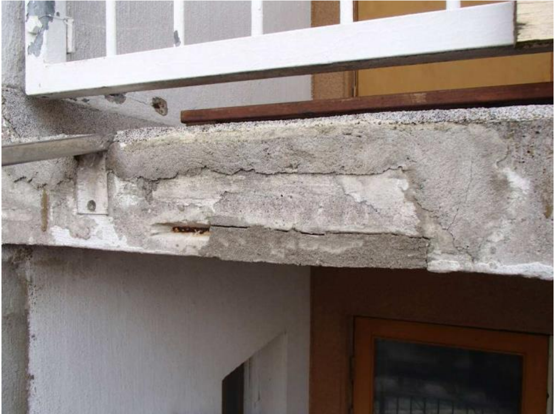
KUVA 6. Parvekelaattojen otsapintoja on jonkin verran laastipaikattu ja paikkaukset irtoilevat (Raksystems, Kuntotutkimusraportti Koivikkotie 5).
