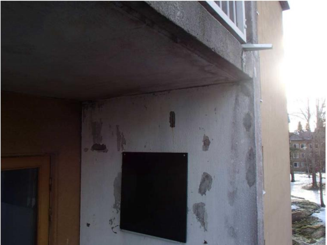
KUVA 5. Pielielementtien pinnoissa on havaittavissa likaantumista ja vaurioita. (Raksystems, Kuntotutkimusraportti Koivikkotie 5).
