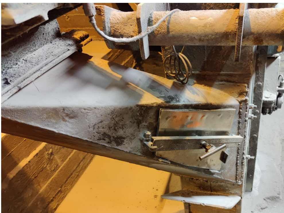
KUVA 11. Kammion alaruuvien ja elevaattorin välinen huoltoluukku
