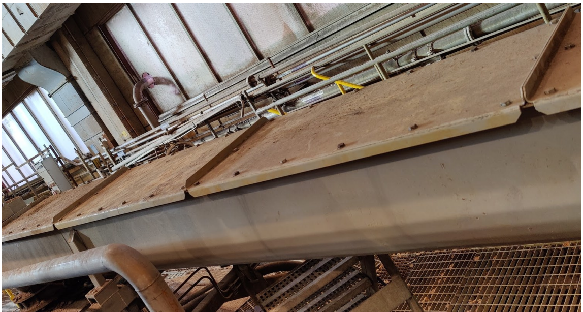
KUVA 15. Kiinteä suojus Boliden Kokkola Oy:n tehtaalla
