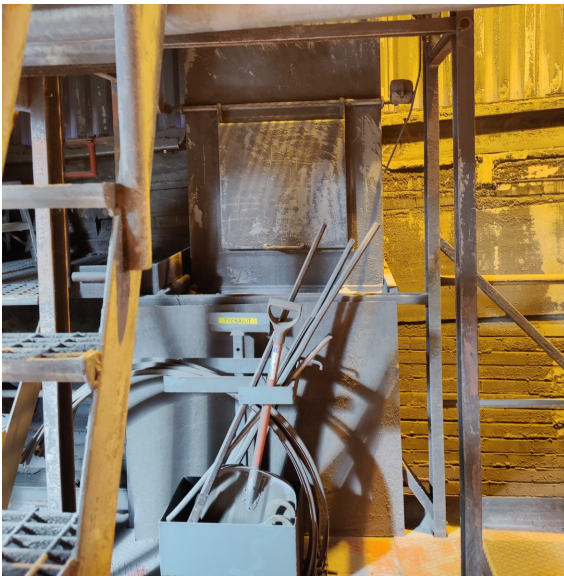
KUVA 13. Rakeistuksen elevaattorin huoltoluukku
