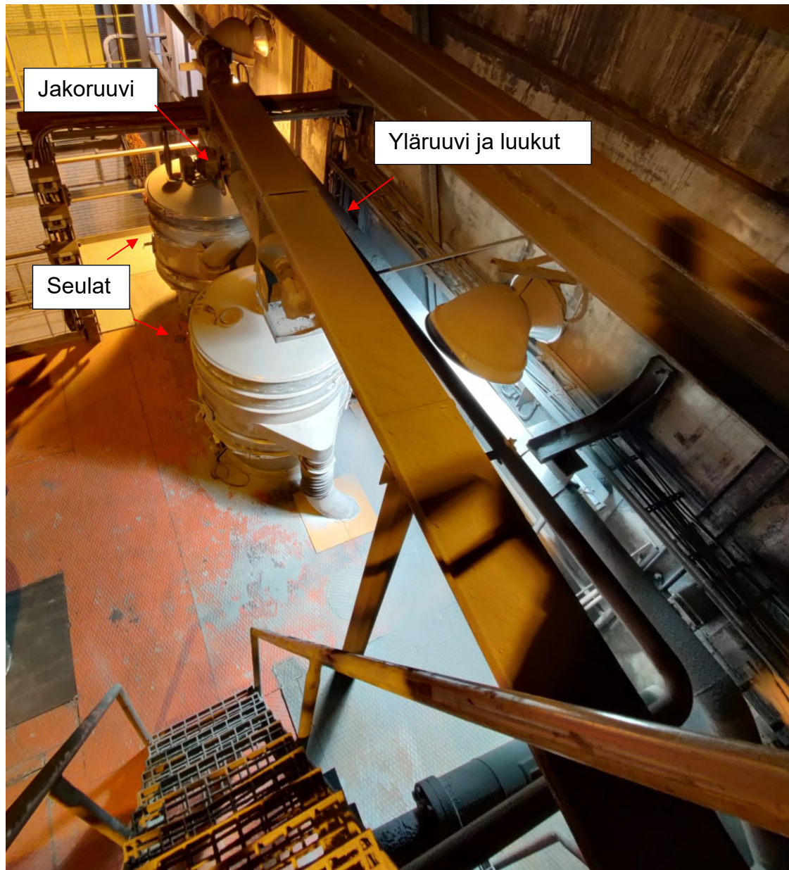
KUVA 14. Rakeistuksen seulojen jakoruuvi ja yläruuvien huoltoluukut
