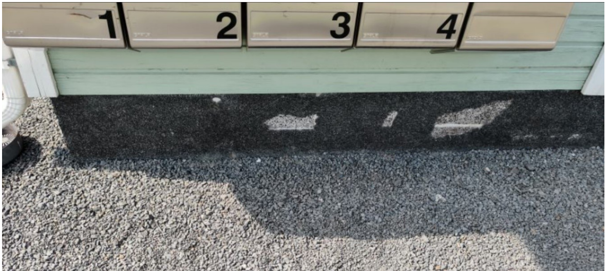
Kuva 12. Autokatoksen sokkelin rappaus on halkeillut molemmin puolin.
