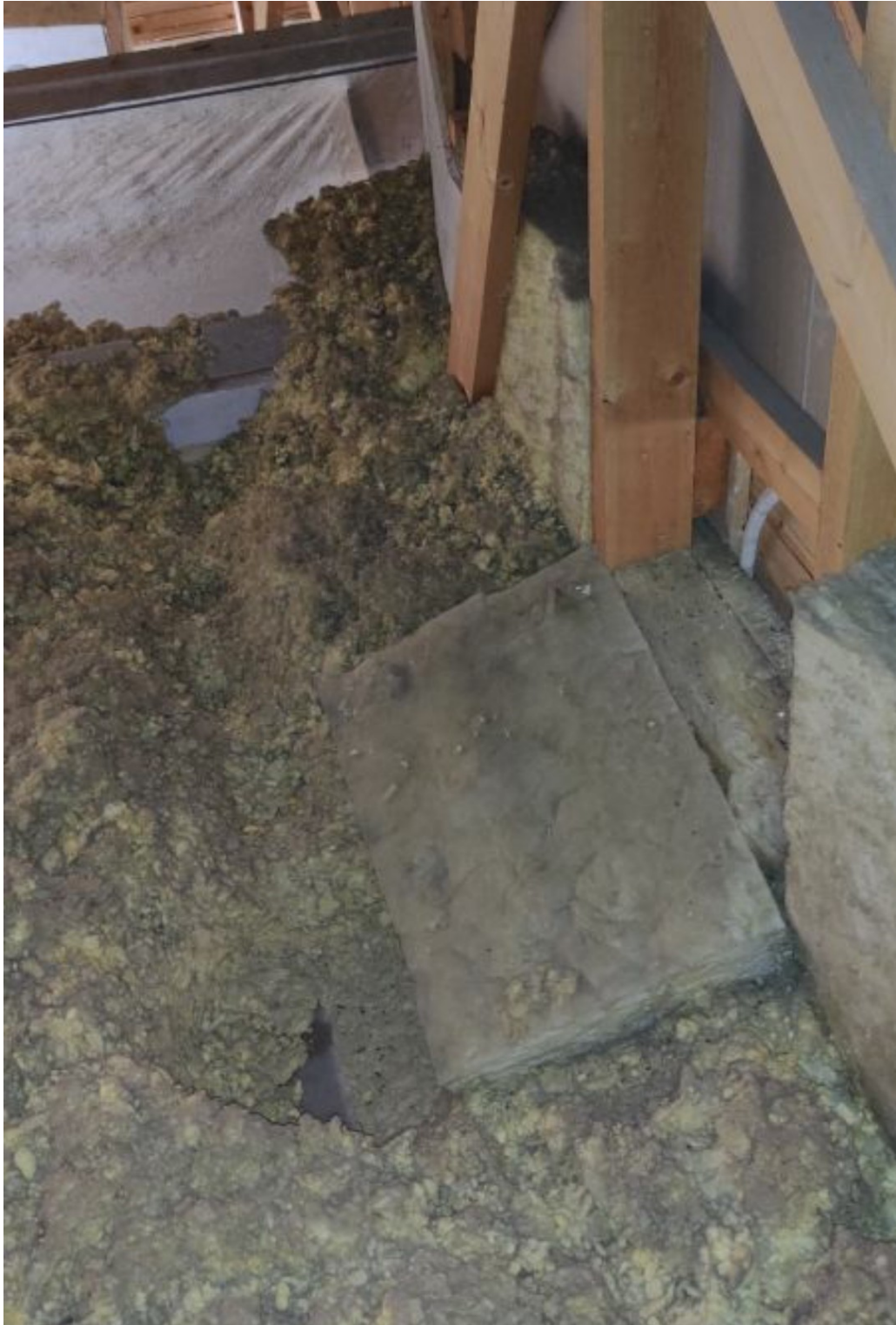
Kuva 18. Paikoiltaan lähteneitä ja kasaan painuneita eristevilloja.
