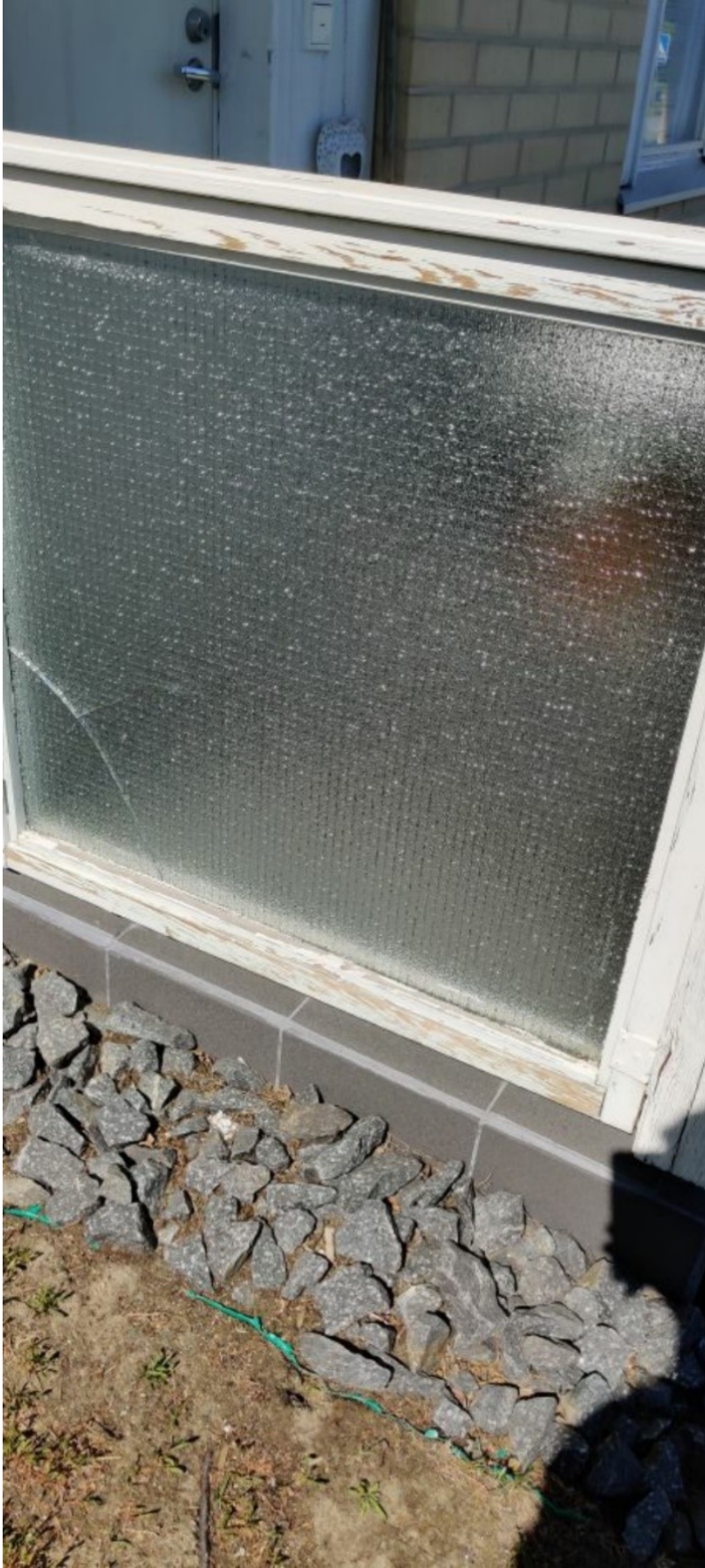
Kuva 9. Asunnon 1 rikkoutunut lasitettu terassiaita.
