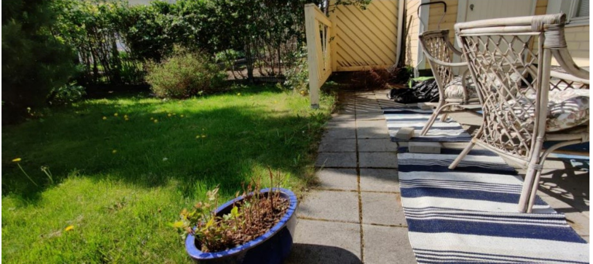
Kuva 7. Talon eteläpuoli / takapiha. Maan kallistukset eivät ole tarpeeksi riittävät asuntojen 2 ja 3 kohdalla.
