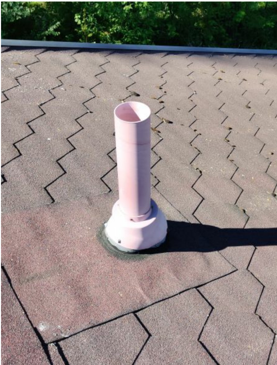
Kuva 17. Puuttuva ilmastointihormin huppu.
