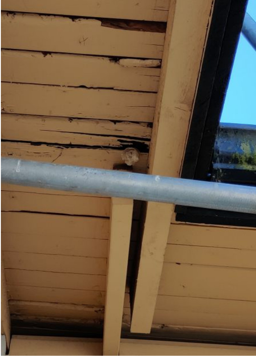
Kuva 15. Teknisen tilan kohdassa oleva katon vuotokohta alapuolelta.
