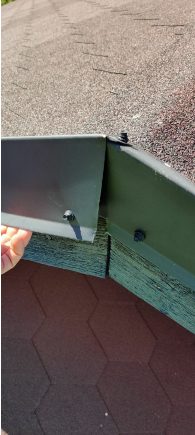
Kuva 16. Päätüräystäspellien kiinnitys on puutteellista.
