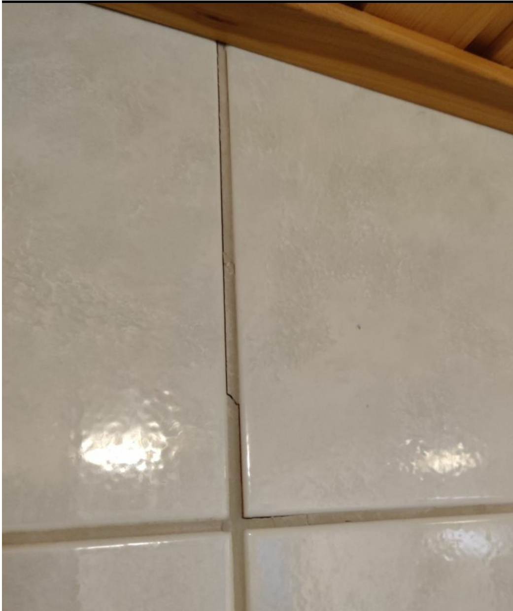
Kuva 19. Pesuhuoneen ja saunan välisen seinän irronnut kopolaatta.
