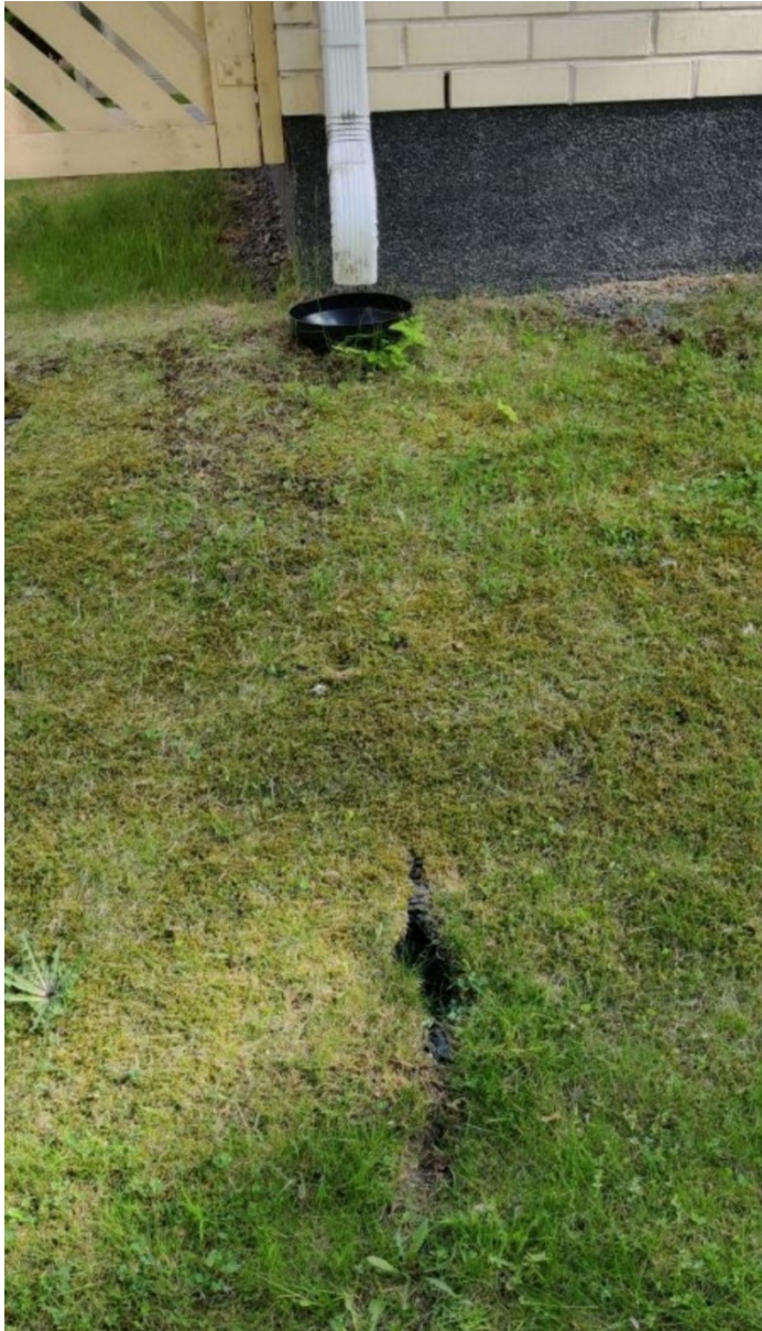
Kuva 11. Länsipuolen sadevesien purkua ei ole tehty huolella
