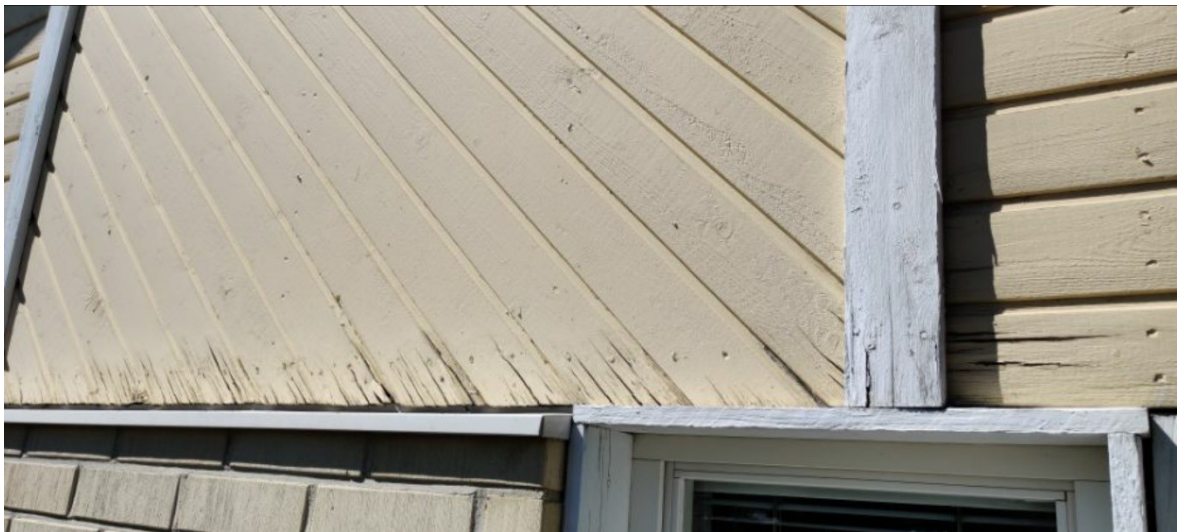
Kuva 13. Puuverhouksen alanurkka on alkanut lahoamaan.
