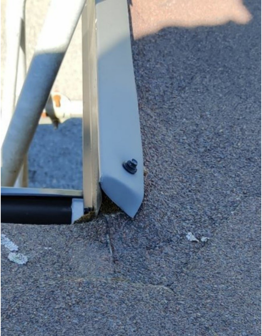
Kuva 14. Teknisen tilan kohdassa oleva katon vuotokohta.
