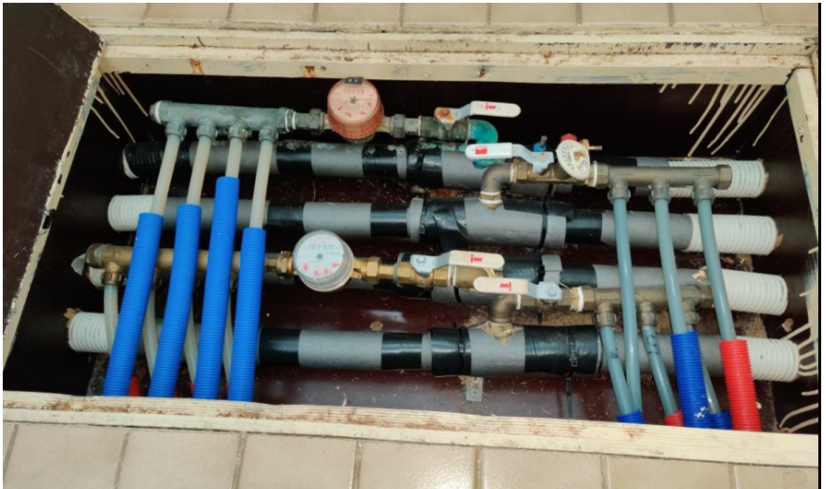
Kuva 20. Jakotukkisyvennyksessä tapahtunut vesivahinko vuonna 2017.
