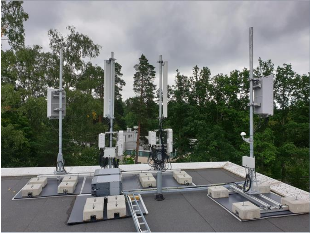
Kuva 25. Esimerkkitukiasemapaikan katon RF-laitteisto ja rakenteet.
