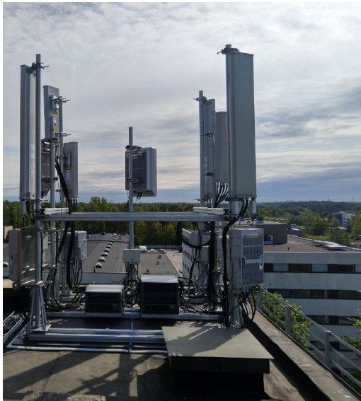
Kuva 1. Katolle asennettu Nokian tukiasemapaikka.
