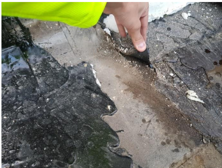
KUVA 24. Vaurioitunut bitumikermin sauma (Pulkkinen 2020, CC BY-ND)
