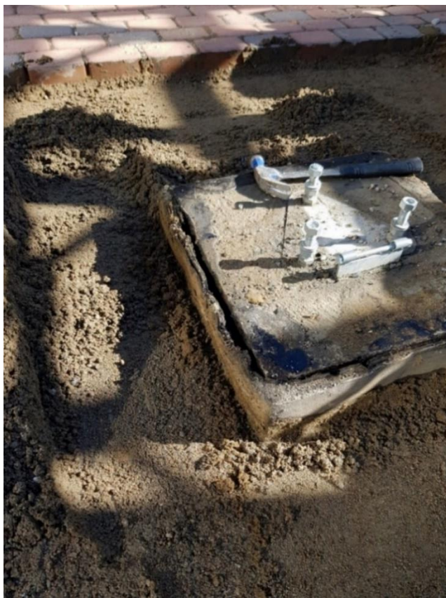
KUVA 21. Lipputangon anturan vedeneristeen ylösnostoa ei käännetty, jonka seurauksena vedet päässeet bitumikermien välissä kulkeutumaan vedeneristekerroksen ja kantavanrakenteen väliin. Aiheuttaen vuodon pihakanteen. Liitteenä video veden aiheuttamasta vauriosta (liite 3).
