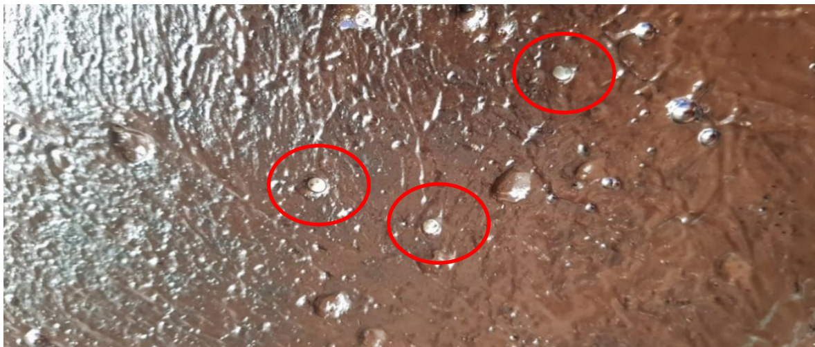
KUVA. 19 Betonin huokoiset, johon Ruiskukumi HB S-200:ta ei ole tunkeutunut ensimmäisessä levityksessä. (Pulkkinen 2020, CC BY-ND)
