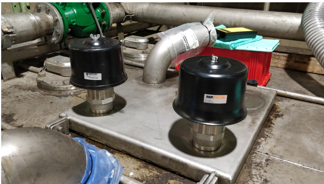
KUVA 31. Kuivanpään kiertovoitelukoneikon FS 120 huohottimet
