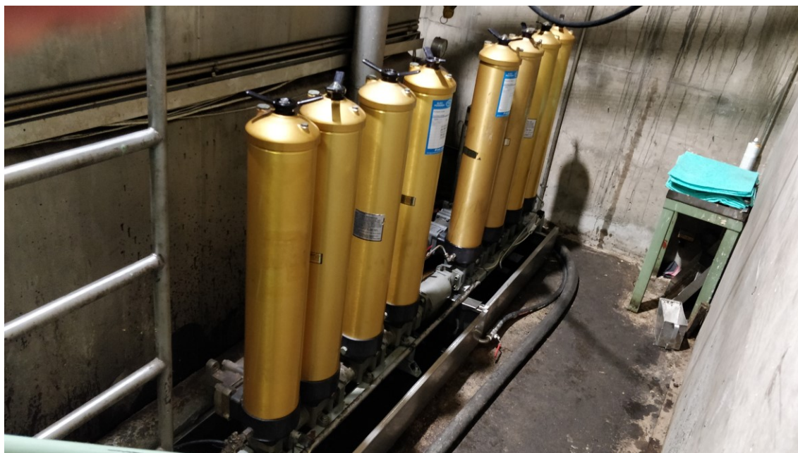
KUVA 20. Kuivanpään kiertovoitelukoneikon Pall-merkkiset painesuodattimet. Kiertovoitelusäiliössä käytetään ainoastaan päävirtausuodatusta
