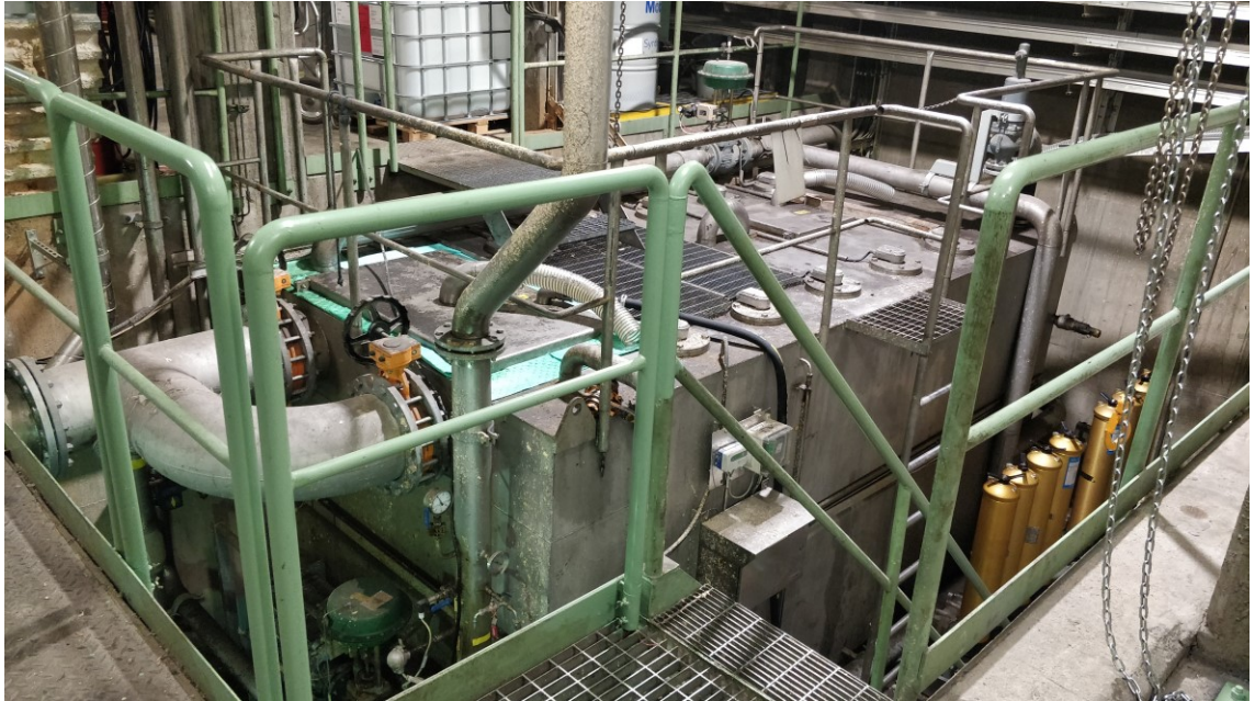
Kuva 29. Kuivanpään kiertovoitelusäiliö, tilavuus 24 kuutiota
