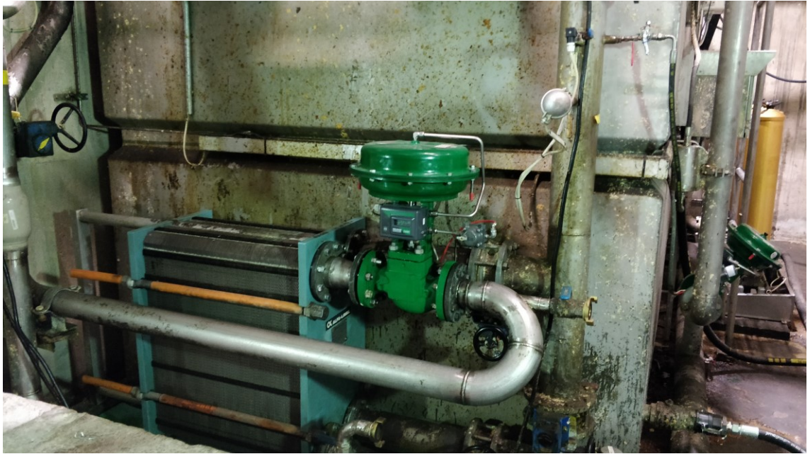
KUVA 30. Kuivanpään kiertovoitelukoneikon Alfa Laval-levylämmönvaihdin
