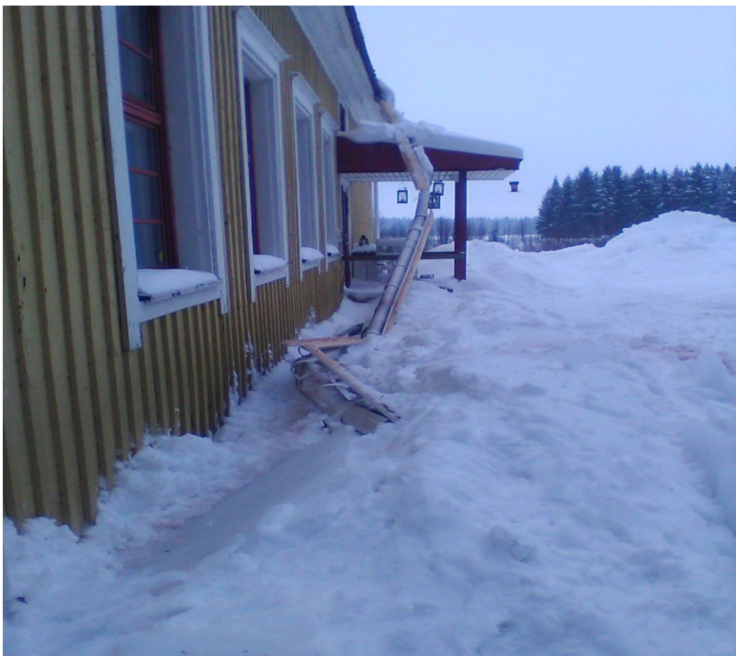
Kuva 9. Räystäskourut tippuneet suunnitteluvirheen ja lumen painon johdosta (Kosken kiinteistö & rakennus Oy 2019)
