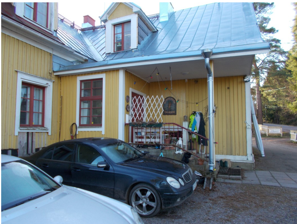
Kuva 8. Valetut betoni portaati tuuletusluukun eteen sekä hirsirunkoa vasten. (itse otettu valokuva)
