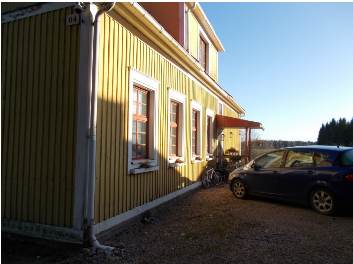
Kuva 1. Maanpinnan kaltevuus rakennusta kohti.
