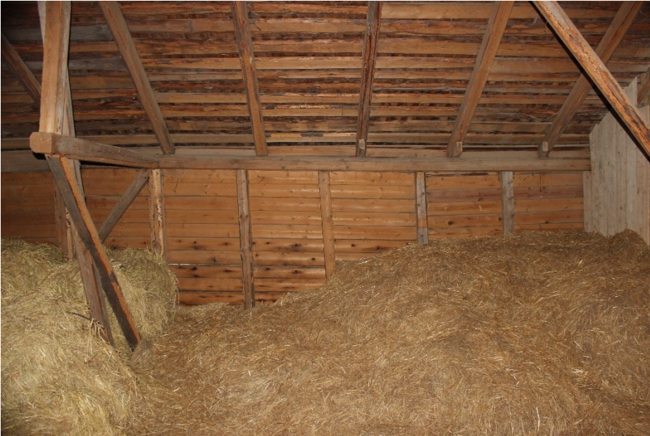
Kuva 32. Rakennuksen puurunkoisen osan painumista.
