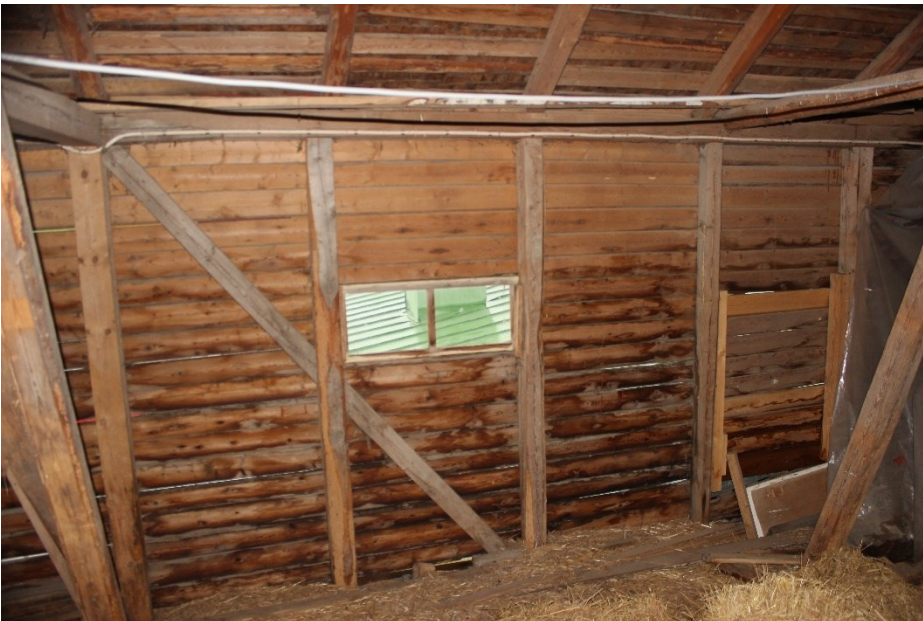
Kuva 27. Puuttuvien räystäskourujen aiheuttamaa vauriota rakennuksen puuverhoukseen tuuletustilasta käsin kuvattuna.
