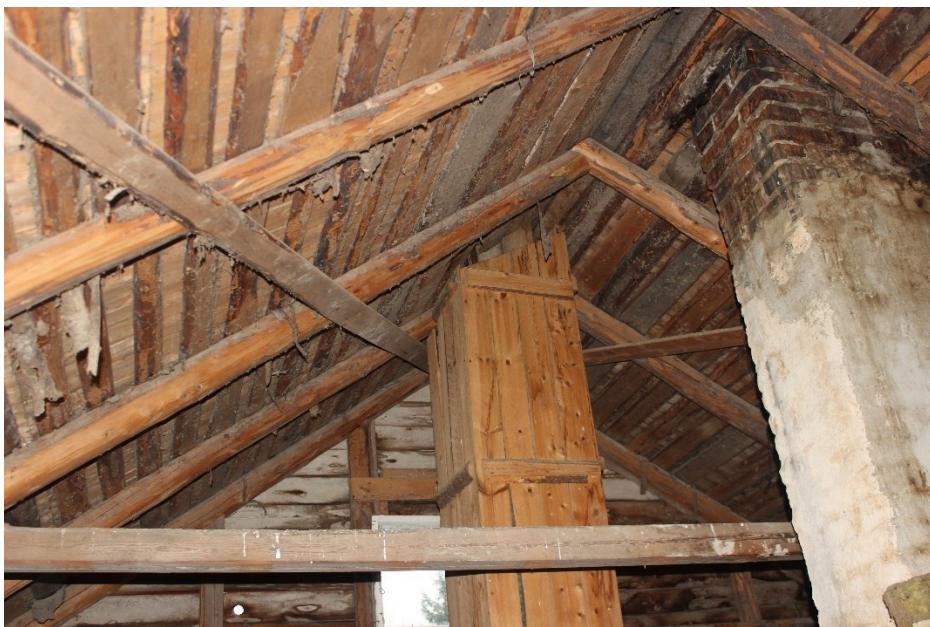
Kuva 23. Savunpoisto- ja ilmanvaihtohormi rakennuksen etelä- päädyssä.
