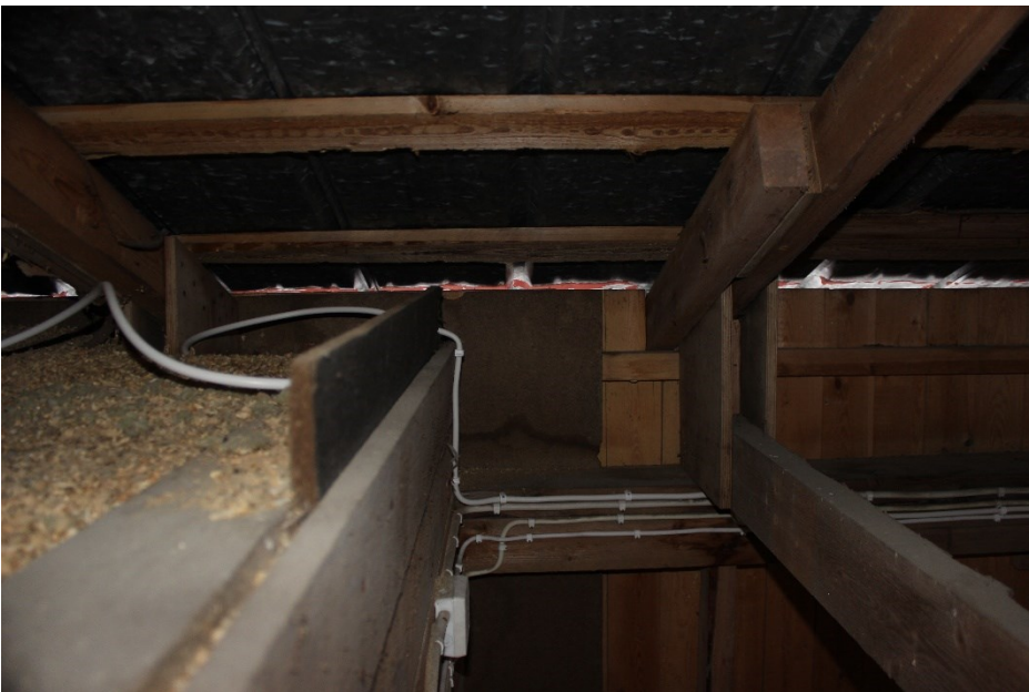
Kuva 9. Tuuletusrako katteen ja ulkovuorauksen välissä, sekä puuttuvat tuulenojaimet.
