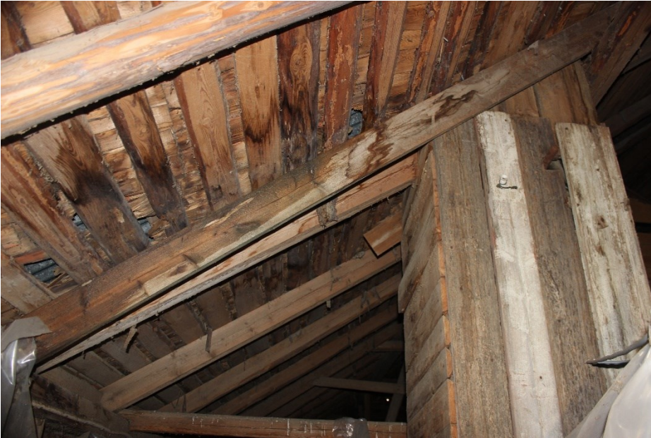
Kuva 25. Suuremman ilmanvaihtohormin vuotovaurioita.
