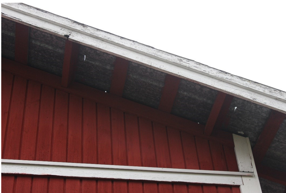
Kuva 6. Reikiä katepellissä, rakennuksen eteläpäädyssä.
