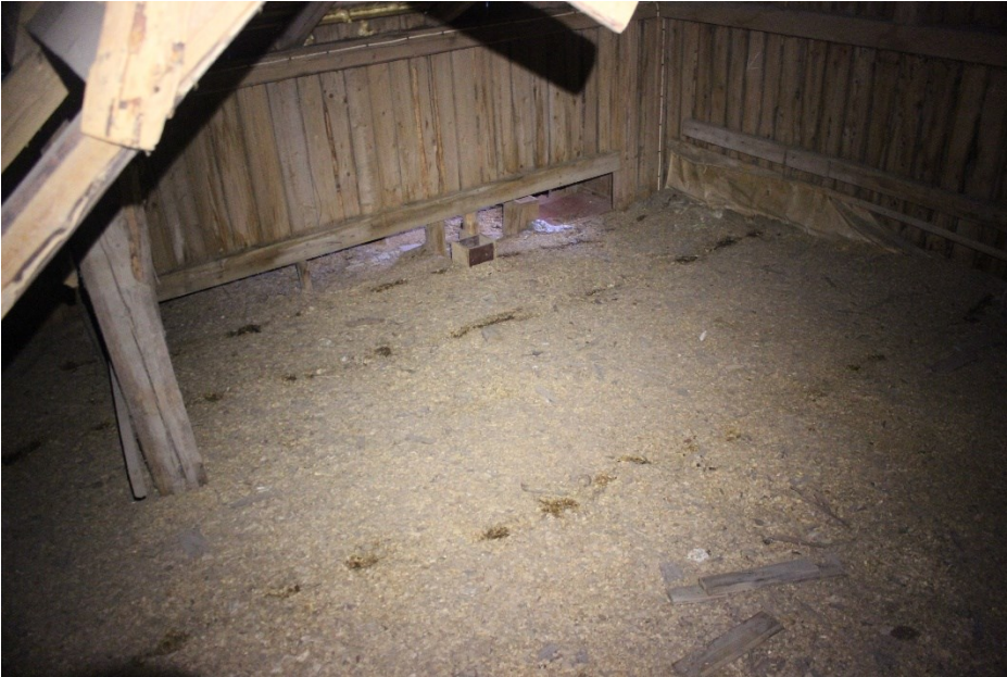
Kuva 38. Kondenssivesiä välipohjan eristeiden päällä.
