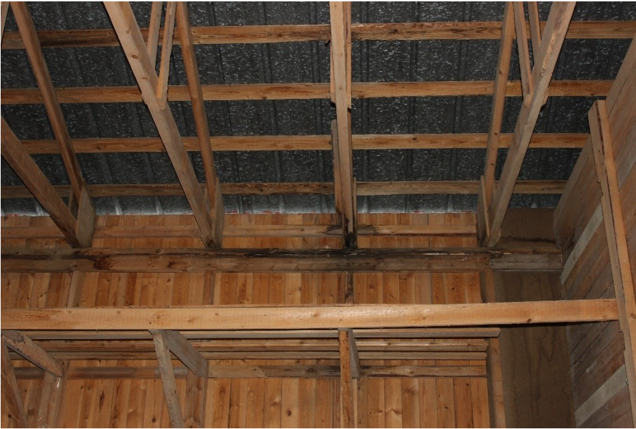
Kuva 8. Aluskatteeton rakenne ja vuotovaurio.
