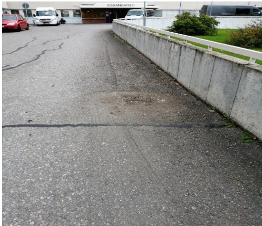
Kuva 9. Asfaltissa painauma pääväylällä.
