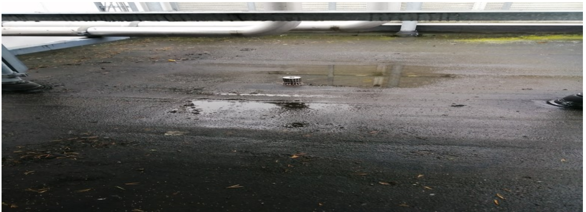
Kuva 73. Vesikatolla katupölyä, lehtiä ja havunneulasia.
