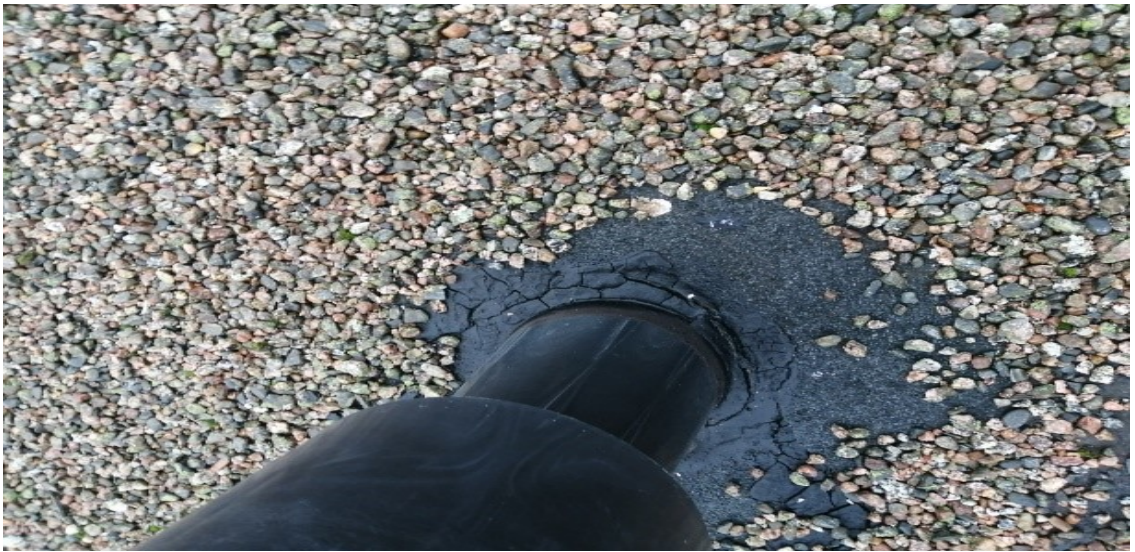
Kuva 60. Putken juuri murtunut.
