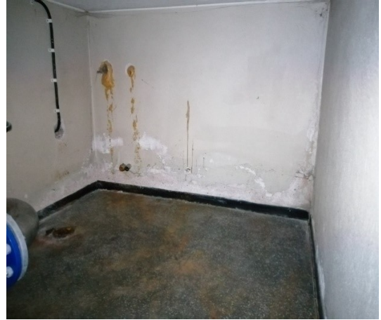
Kuva 33. Maali ja tasoite hilseilee.
