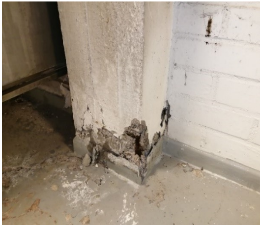
Kuva 34. Pilarin juuri rapautunut.
