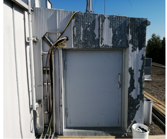
Kuva 62. Maali hilseilee, seinässä reikiä.
