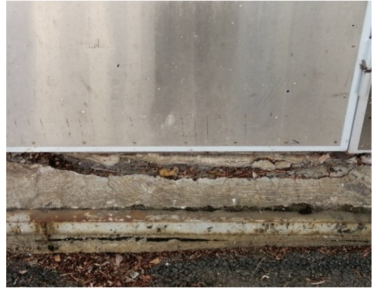
Kuva 25. Kynnyksen betoni vaurioitunut.
