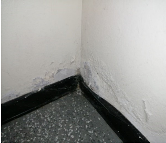
Kuva 32. Maali ja tasoite hilseilee.
