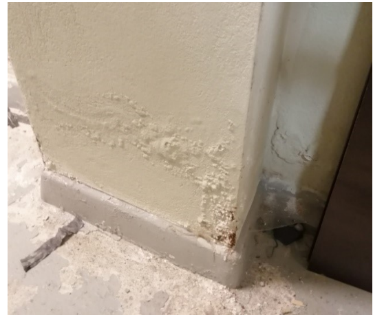
Kuva 35. Pilarin juuri hilseilee.
