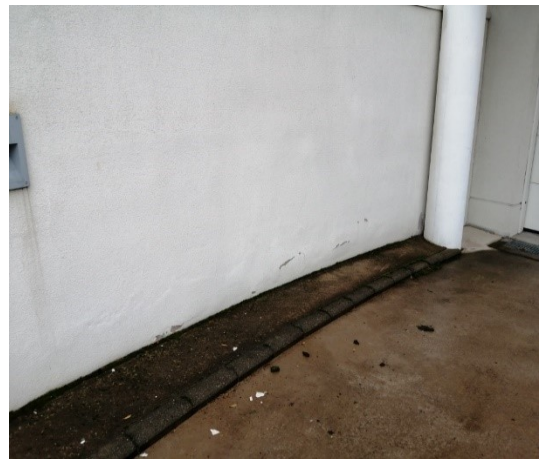
Kuva 23. Tukimuurin pinnoite irtoilee.
