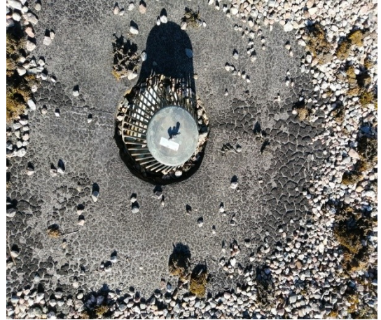
Kuva 69. Vesikatteen pinta kulunut.
