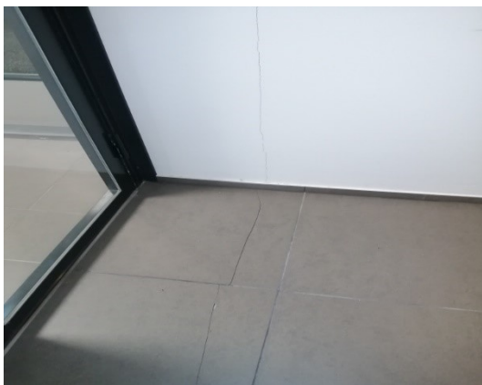
Kuva 99. F0 lattiassa ja seinässä halkeama.
