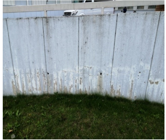
Kuva 19. Muottitukien reikiä ja hilseilyä.
