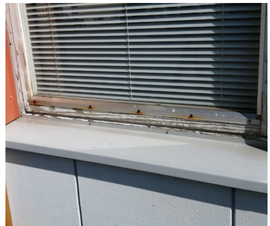
Kuva 54. Vanhan ikkunan kunto.
