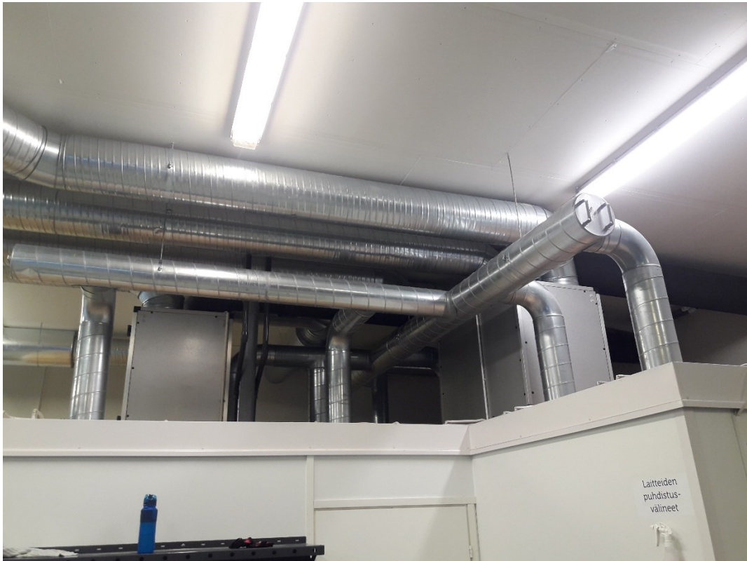
Kuva 2. Ilox 297 -ilmanvaihtokoneet ja kanavistoa osa 1.
