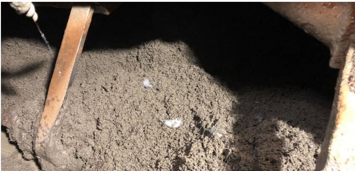
Kuva 8. Kuitupaakkuja ja pieni vesivuoto betoninsekoittimessa.
