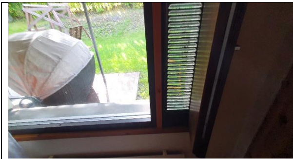
Kuva 11. Tuuletusikkunoiden toiminta on paikoin puutteellista
