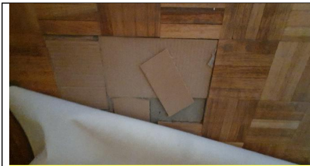
Kuva 5. Mosaiikkiparketti on paikoin irti alustastaan ja aukkoa on paikattu pahvilla.
