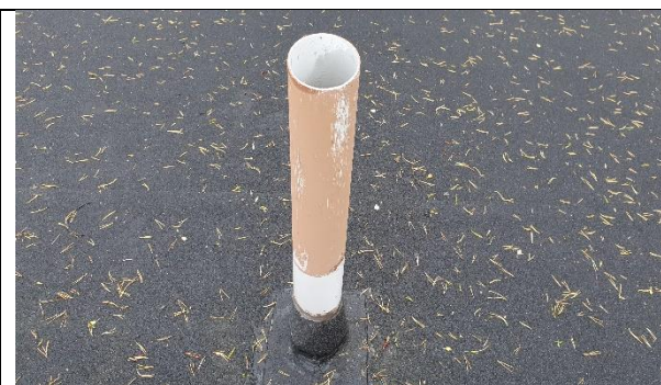
Kuva 29. Viemäriin tuuletusputki vesikatolla
