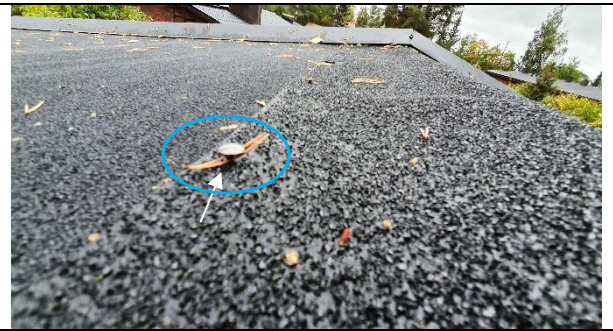
Kuva 18. Ylös nousseita huopanauloja harjalevyssä
