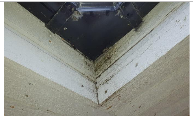
Kuva 2. Räystään tippapelti on valuttanut vettä ohi vesikourusta aiheuttaen tummumaa räystääslaudoituksessa
