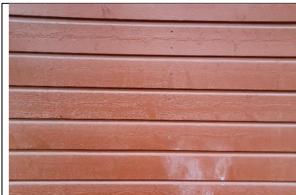
Kuva 9. Paneelipinnat ovat pääosin hyväkuntoisia
