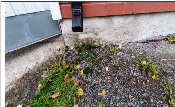
Kuva 1. Sadevedet ohjautuvat osalla rakennusta rakennuksen vierustalle
