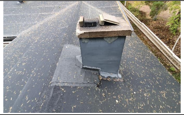
Kuva 16. Savupiipun harjan puolelle on lammikoitunut vettä, jolloin on asennettu kiila estämään veden lammikoitumista
