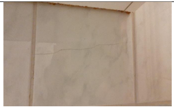
Kuva 24. Haljennut laatta peilikaapin alapuolella
