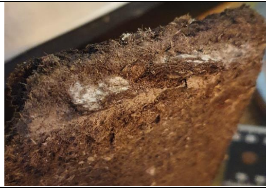
Kuva 8. Tuulensuojalevyn alapinnassa kosteuden aiheuttamia vaurioita
