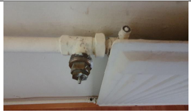
Kuva 26. Rakennusaikaiset venttiilit lämmitysverkossa
