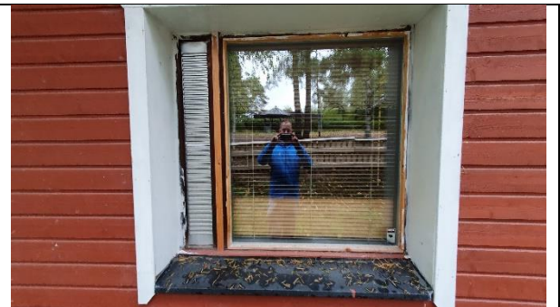
Kuva 12. Ikkunaelementti, josta uloin lasi on vaihdettu. Vesipeltien kallistukset ovat puutteelliset.
