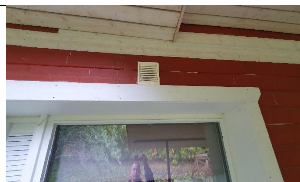
Kuva 31. Makuutiloihin on asennettu korvausilmaventtiilit ikkunoiden yläpuolelle.
