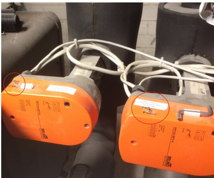
Kuva 26. Säätöventtiilien toimilaitteiden vaihtokytkimet.
