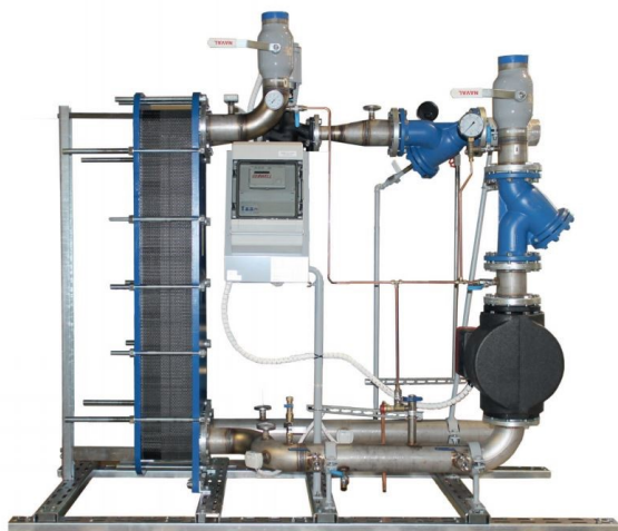
Kuva 23. Yksipiirinen kylälaiteisto, joka sisältää yhden jäähdytyspiirin lämmönsiirtimen, säätöventtiilin, pumppun ja muut putkiston varusteet (31).
