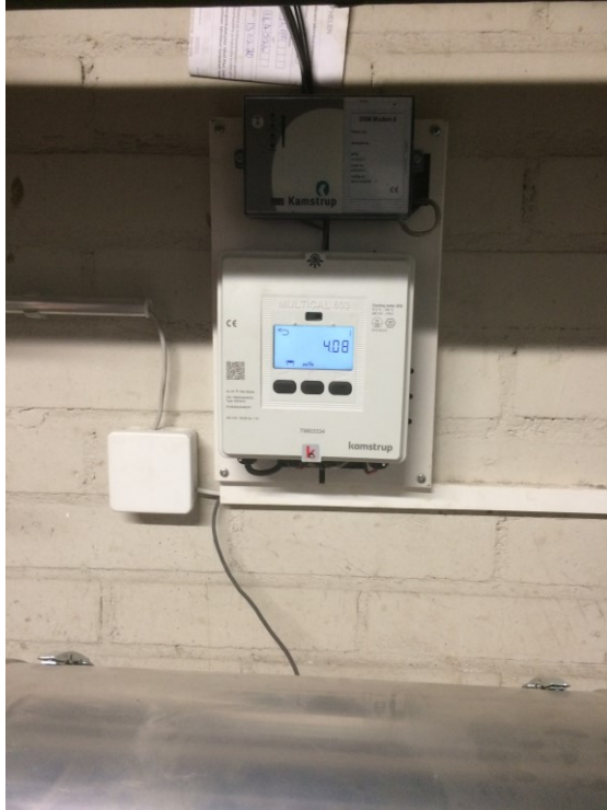
Kuva 28. Energiamittari ja sen yläpuolella oleva modeemi.
