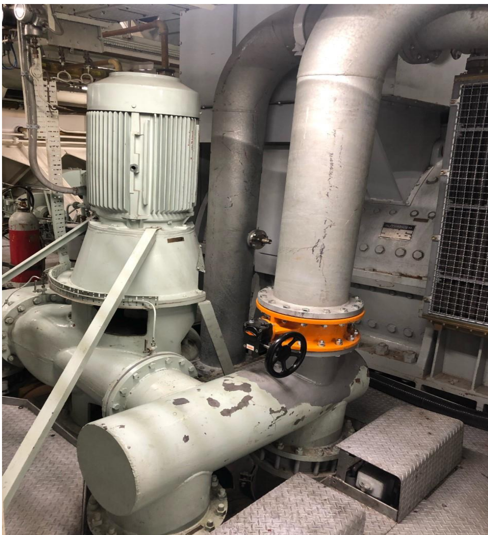
Kuva 3. Sähkömoottorivetoinen viippauspumppu. Kuvasta voi nähdä uudelleen rakennettu painepuolen putkistomuutos, jolle on tehty läpivienti laipion läpi uuteen käsittelyjärjestelmään. (N.Lindström 2019)
