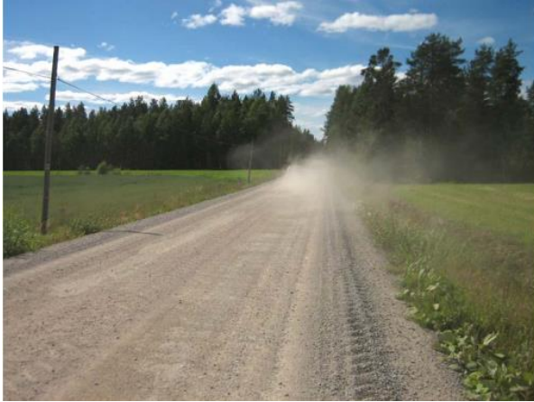
KUVA 5. Kuntoluokka 1: tie pölyää runsaasti (7, s. 18)
