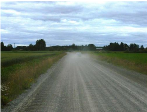
KUVA 6. Kuntoluokka 2: tie pölyää kohtalaisesti (7, s. 18)
