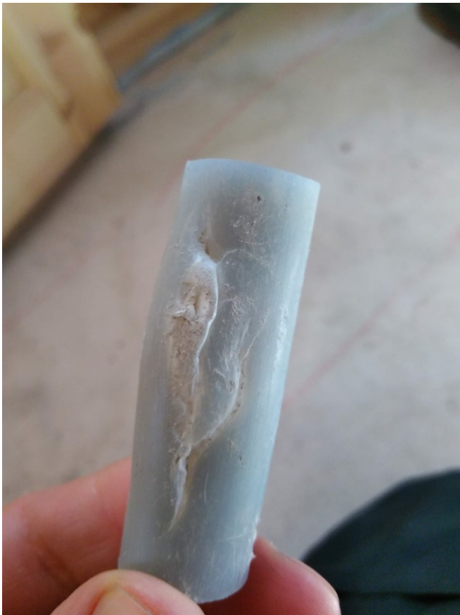
Kuva 24. Jäätymisen seurauksena rikkoutunut lattialämmitysputki.
