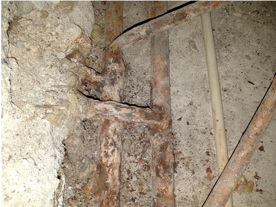
Kuva 28. Vuotopaikka piikattuna auki kph:n lattiassa. Suihkuvesi on päässyt vuosien ajan puutteellisen vedeneristyksen vuoksi lattiaan ja aiheuttanut ruostumisen seurauksena vuodon.
