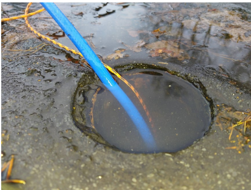
Kuva 20. Vedenpinta laskee aluksi ja pysähtyy sitten kuvan tasoon. Tämä osoittaa, että katto-kaivon ja kattohuovan liitos vuotaa.
