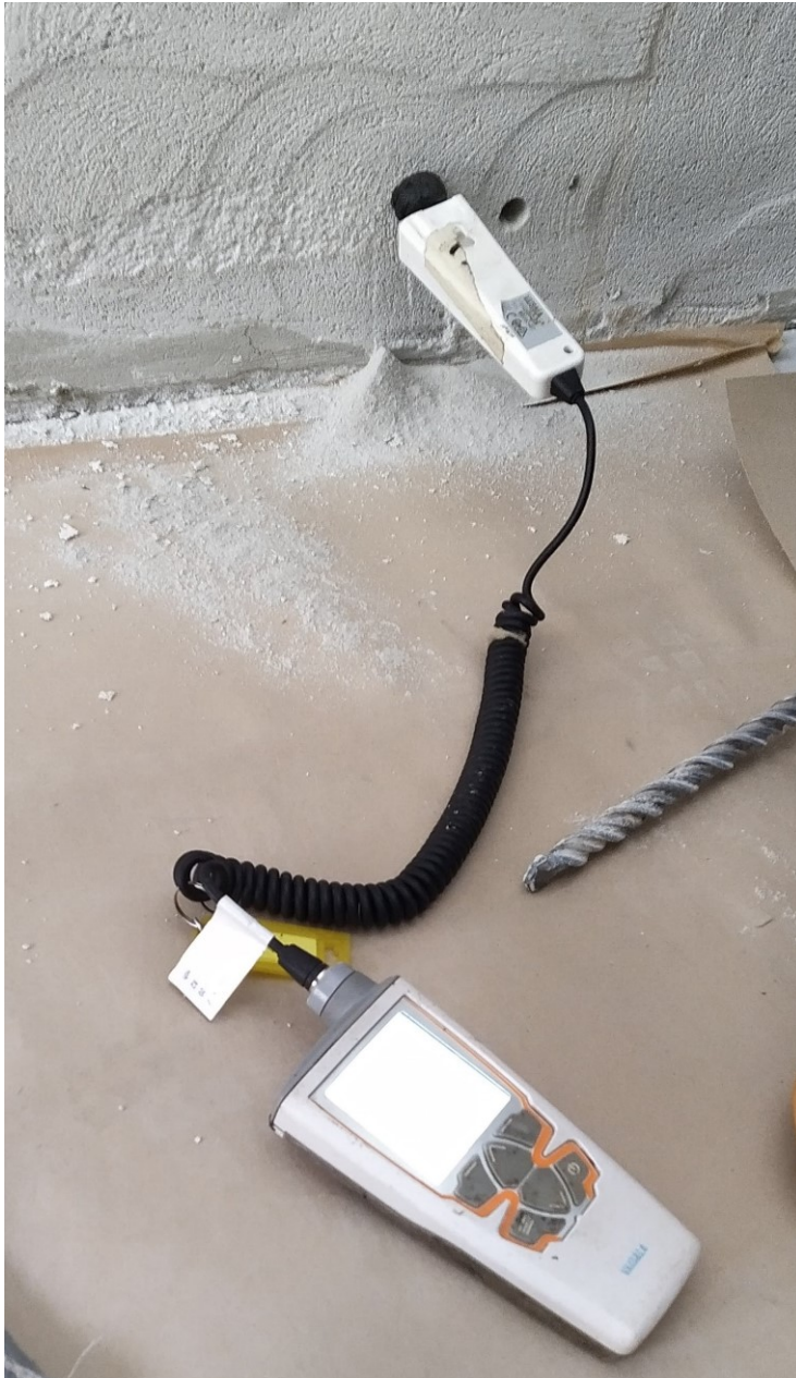
Kuva 6. Eristetilan kosteusmittaus Vaisala Humicap -kosteusmittarilla.
