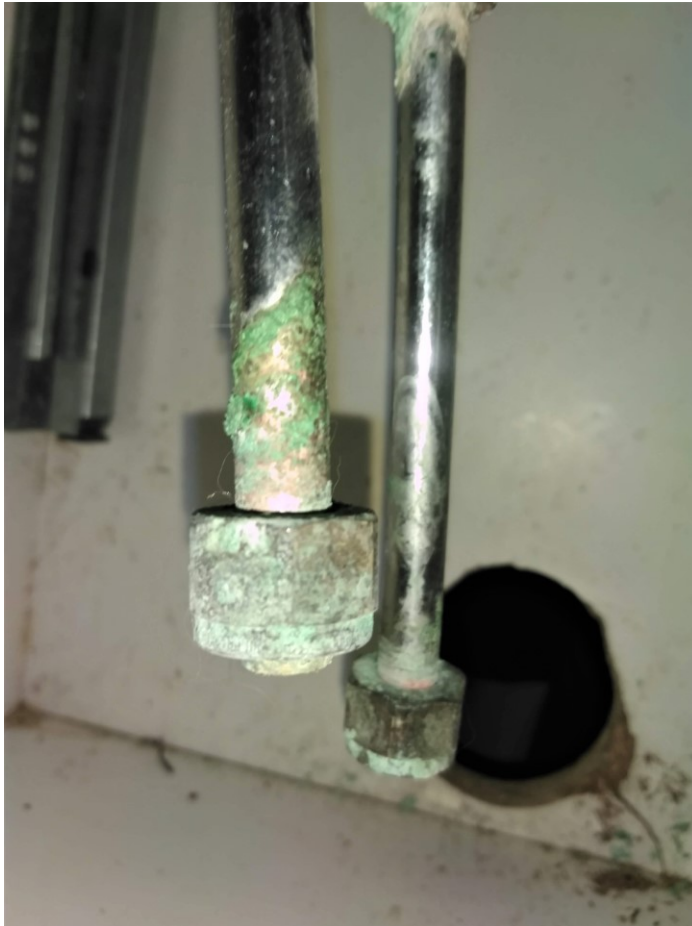
Kuva 25. Vuodon aiheuttanut keittiön hanan liitos.
