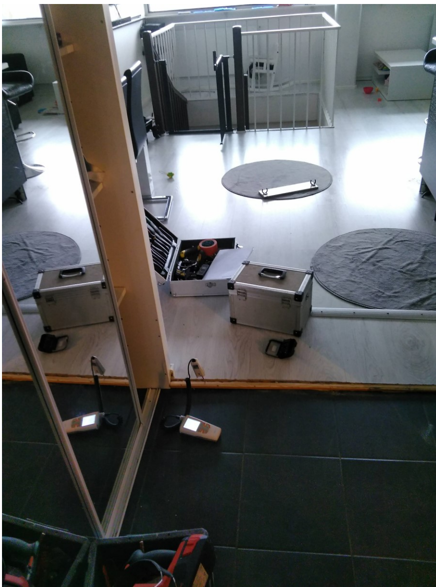
Kuva 22. Välipohjan eristeen kosteuden mittaus. Porareikä on tehty kynnyksen alle, jotta pintoja ei vahingoitettaisi. Tässä tapauksessa ne jouduttiin kuitenkin purkamaan.
