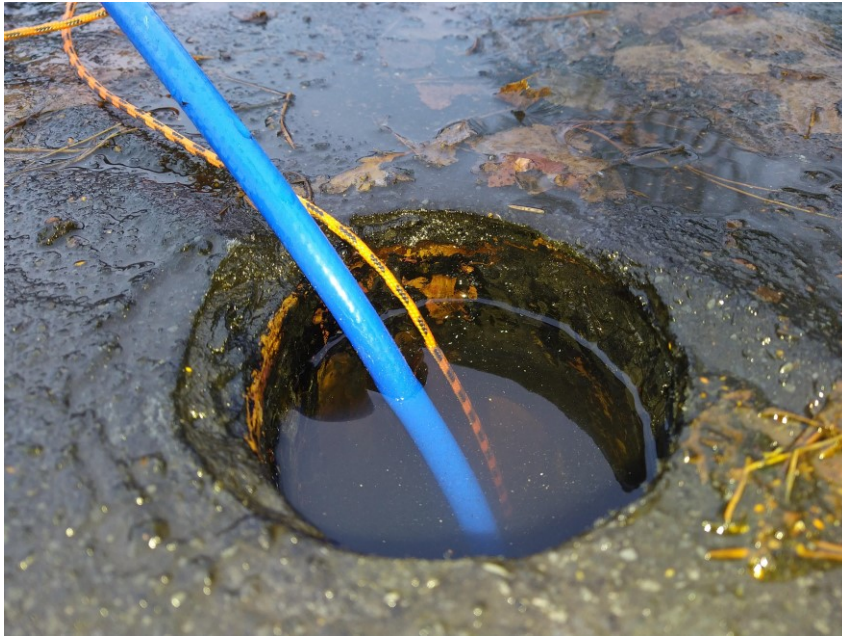
Kuva 18. Kattokaivon padotus. Padotuspallo on viety ensi syvemmälle kaivoon ja täytetty kuvan tasoon saakka. Pinta ei laske. Sadevesiviemärissä ei ole vuotoa kuvan pinnantason ja padotuspallon välissä.
