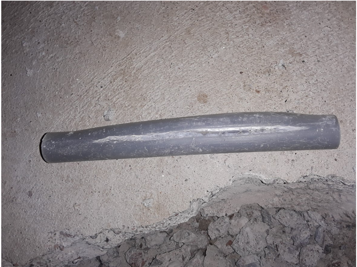
Kuva 13. Kuvassa on kuuntelemalla löydetty, jäätyksen seurauksena rikkoutunut lattialämmitysputki.
