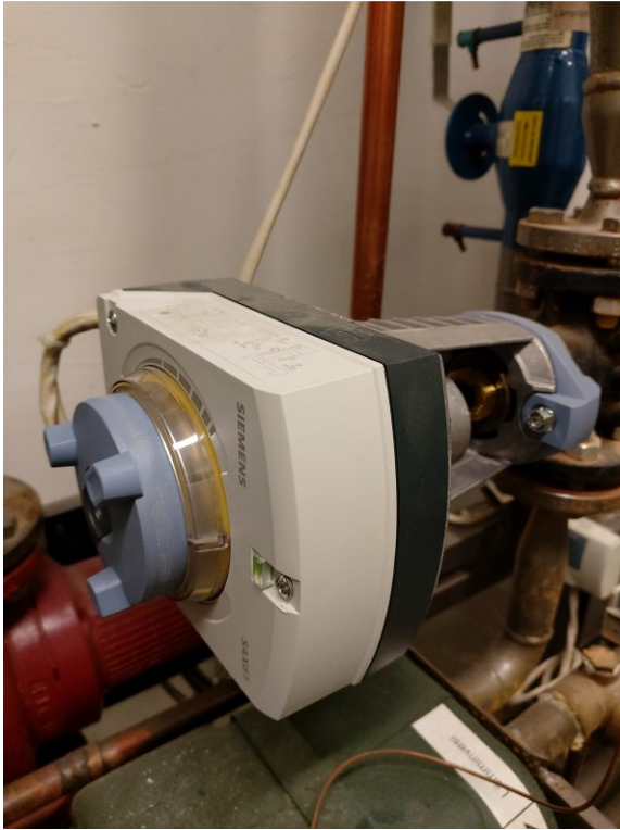
KUVA 14. Venttiilin toimilaitte. Vanhat toimilaitteet hyödynnettiin saneerauksessa
