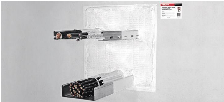
KUVA 7. Palokatkopinnoite (HILTI Oy).
