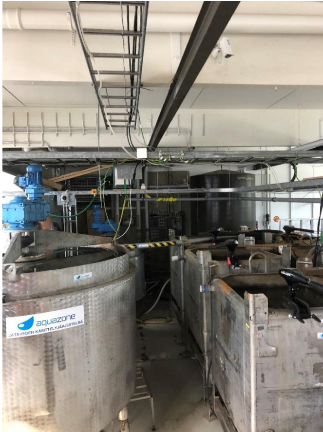
Kuva 16 MBR-koelaitos; esiselkeytyks (vasemmalla) ja anox-altaat (oikealla) (Pekonen, 2020.)
