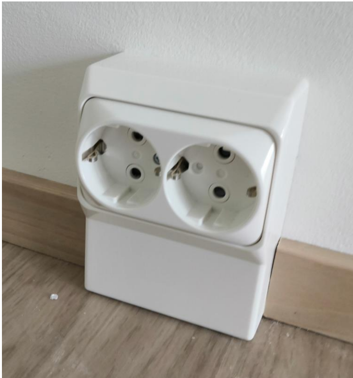
Kuva 8. Pientä ilmavuotoa tuntui myös pistorasian läpiviennissä.
