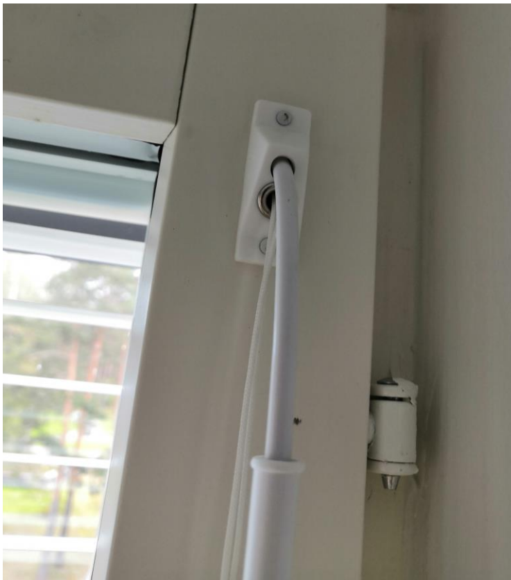
Kuva 7. Sälekaihtimen säätimen läpivientiaukko, josta tuntui pientä vuotoa.
