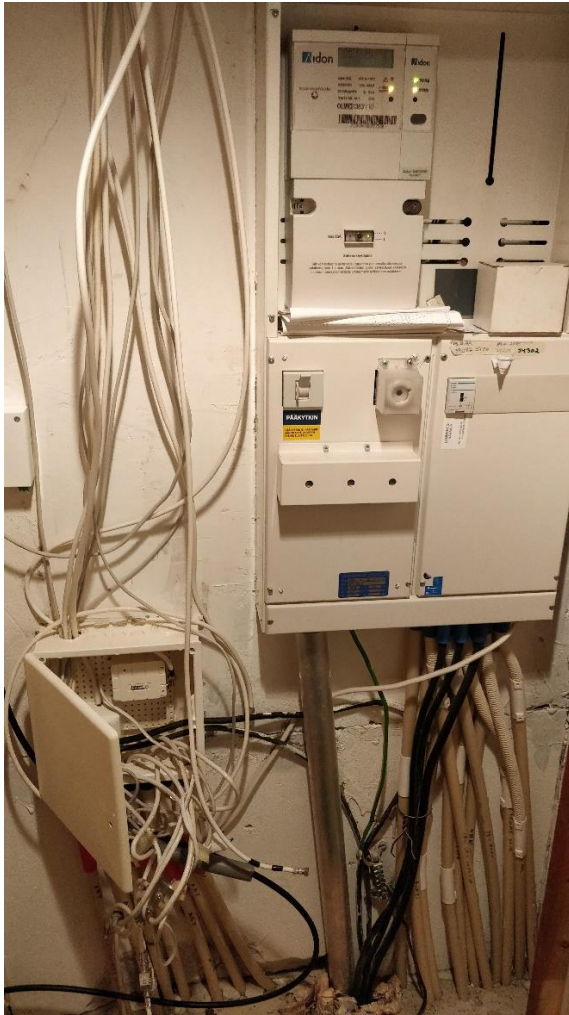
Kuva 11. Sähkökeskus ilman peitelevyä
