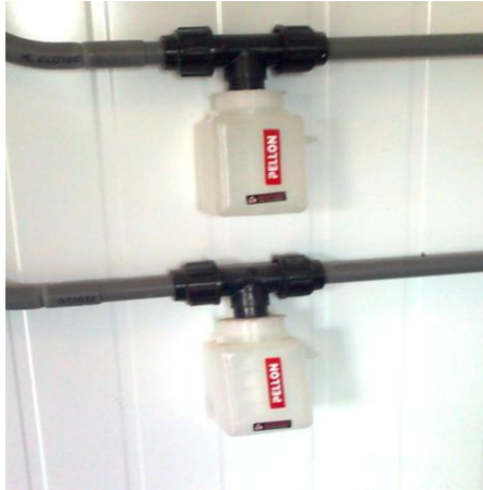
Kuva 12. Näytteenottoputkisto ja kondenssivesisäiliöt
