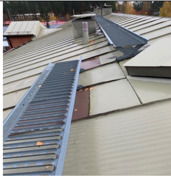
Kuva 46. N-talon kattotikkaat hyväkuntoiset, mutta asennettu vinoon (Termonen 2020 CC BY-SA)
