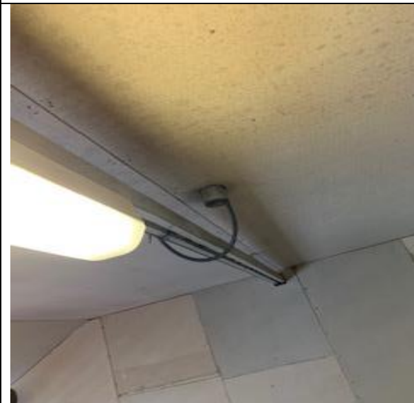
Kuva 3. Havaittu läpiviennin vuotokohta, tiivistykset tarkastettava (Termonen 2020 CC BY-SA)
