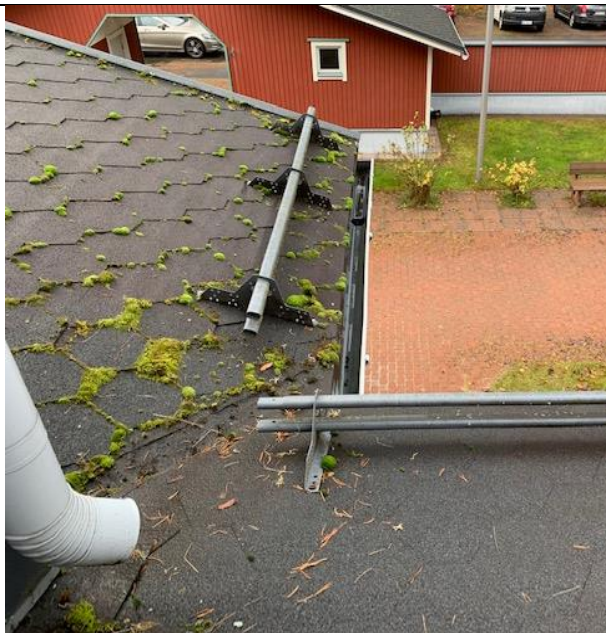
Kuva 12. Vesikaton taitekohdissa havaittu sammalkertymää (Termonen 2020 CC BY-SA)
