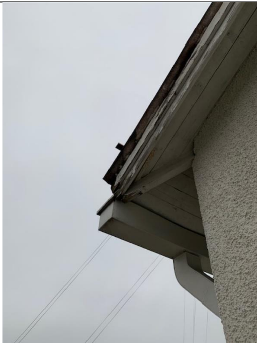
Kuva 82. Räystäällä havaittavissa lahoa 8-talossa (Termonen 2020 CC BY-SA)
