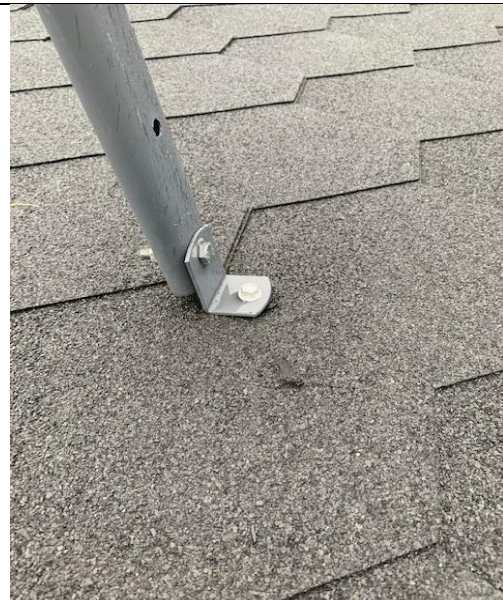
Kuva 33. Kattotikkaiden kiinnityspiste voi olla vuosien päästä vuodon aiheuttaja (Termonen 2020 CC BY-SA)
