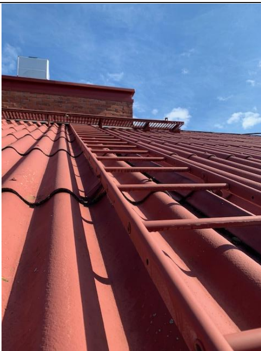
Kuva 77. Kattotikkaat ja kävelysillat hyväkuntoisia (Termonen 2020 CC BY-SA)
