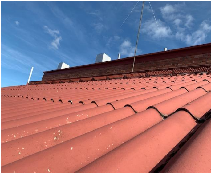
Kuva 75. Kate pääosin hyväkuntoinen, havaittu hieman hilseilyä maali-pinnassa (Termonen 2020 CC BY-SA)
