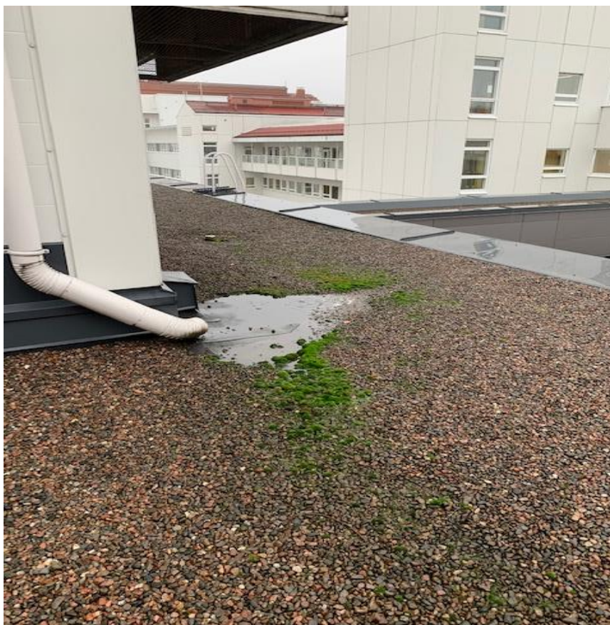
Kuva 4. G-talon sadevesien ohjauksessa puutteita sammalkertymän aiheuttamana (Termonen 2020)
