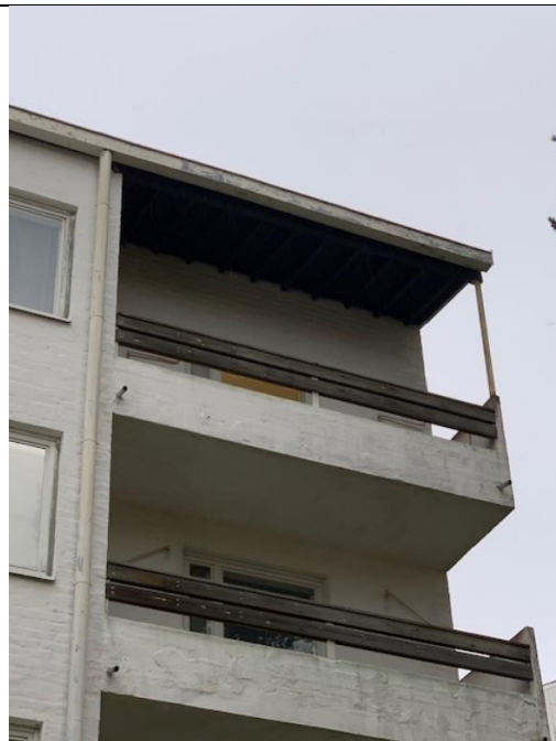
Kuva 88. Sadevesikourujen maali hilseillyt (Termonen 2020 CC BY-SA)
