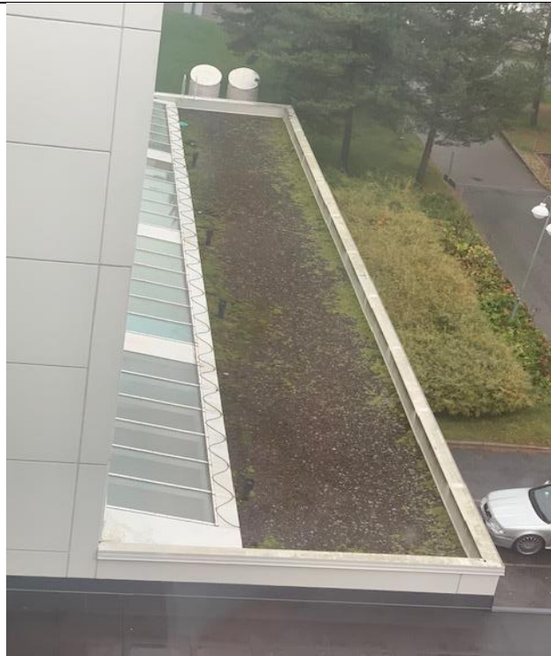
Kuva 31. Sammalkertymä tasakattoisen kevytsorakatoksen päällä (Termonen 2020 CC BY-SA)
