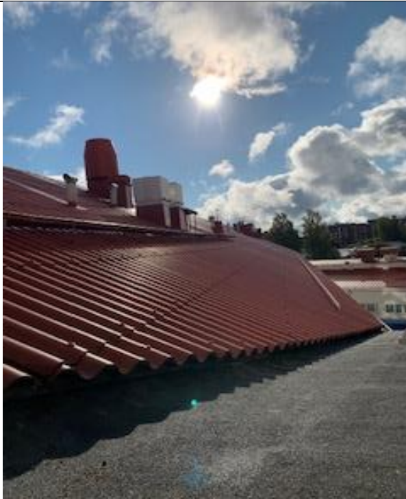
Kuva 11. Varttikate läpivientejä ja liitosalue A-siipeen (Termonen 2020 CC BY-SA)
