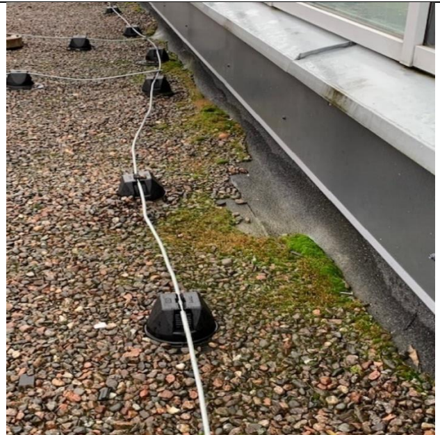
Kuva 58. Havaittu sammalkertymää katteella (Termonen 2020 CC BY-SA)
