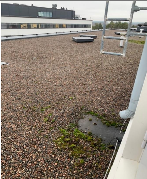
Kuva 50. K-talon tasakattoisilla osuuksilla havaittu sammalkertymää, suurin osa kertymästä sadevesien ohjauksen yhteydessä (Termonen 2020 CC BY-SA)
