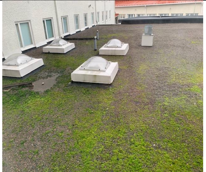
Kuva 36. Yleiskuvaa vesikaton kunnosta ja sammalkertymästä kevytsorakeroksessa, vesikatolla sadevesien ohjauksessa havaittu puutteita (Termonen 2020 CC BY-SA)
