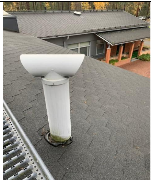
Kuva 13. Läpivientien liitoksissa havaittu sammalkertymää (Termonen 2020 CC BY-SA)
