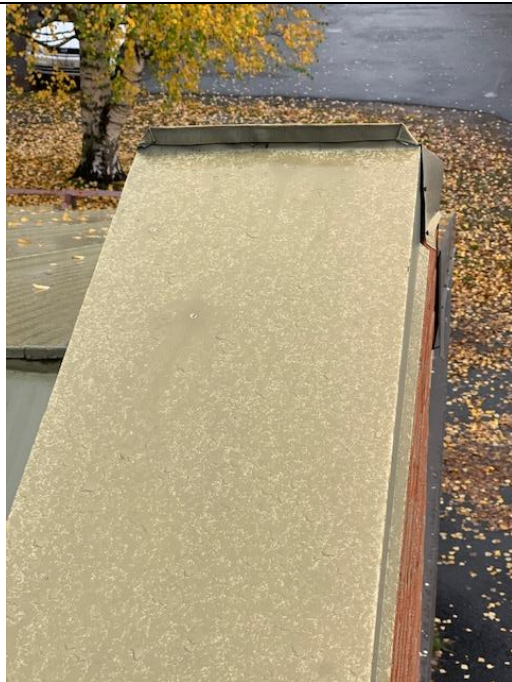
Kuva 22. Reunapellityksissä havaittu naulojen karkailua (Termonen 2020 CC BY-SA)
