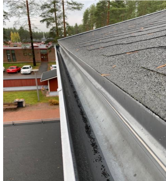
Kuva 12. Sadevesikourujen pohjalla havaittu pieniä määriä huopakatosta irronneita hippuja, jotka eivät estä veden kulua (Termonen 2020 CC BY-SA)
