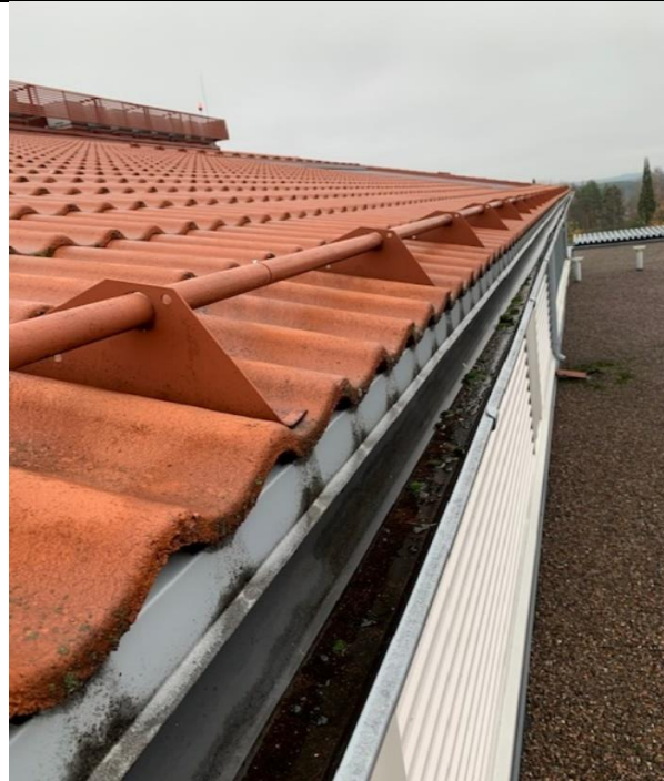
Kuva 51. Harjakatto osuudella havaittavissa tiilikatteen kulumaa sekä sadevesikouruissa likaa (Termonen 2020 CC BY-SA)
