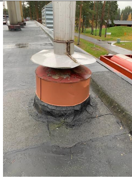
Kuva 7. Läpivientejä käyty paikkaamassa useamman ker- ran (Termonen 2020 CC BY-SA)
