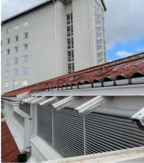
Kuva 6. Kattovasojen ja katteen hilseilyt maali (Termonen 2020 CC BY-SA)
