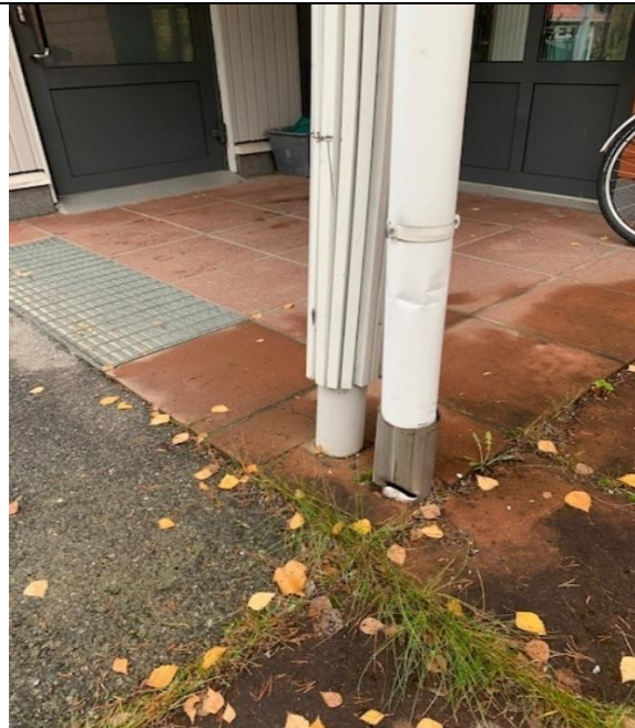
Kuva 51. Kaivon liittyvässä syöksytorvessa havaittu reikä (Termonen 2020 CC BY-SA)
