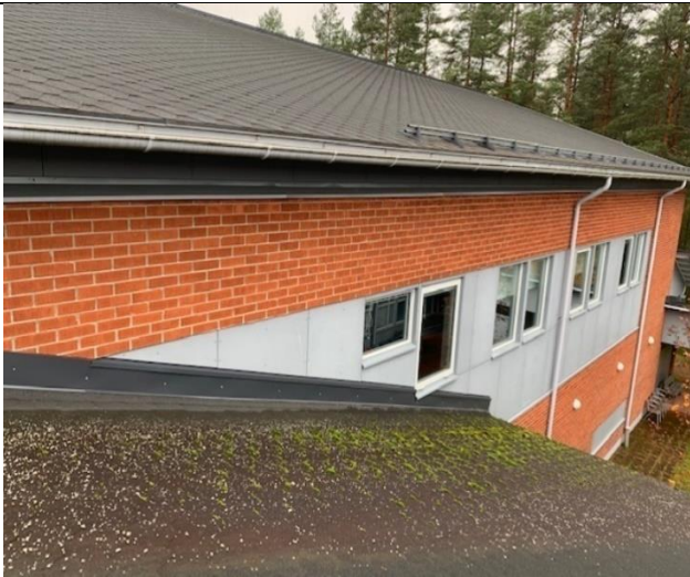
Kuva 55. Liitoskohdassa havaittu sammalkertymää huopakatteella (Termonen 2020 CC BY-SA)
