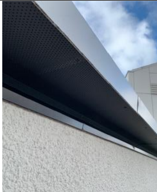
Kuva 41. I-siiven kattopohjan tuuletus toteutettu räystäältä suojaamalla tuuletusrako verkolla (Termonen 2020 CC BY-SA)
