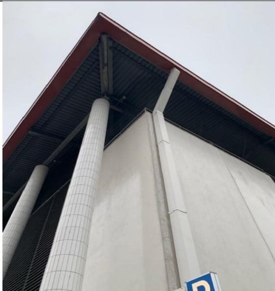
Kuva 67. Sadevesikourussa havaittu ennen syökytorvea tihkuvuotoa vesisateen aikana (Termonen 2020 CC BY-SA)
