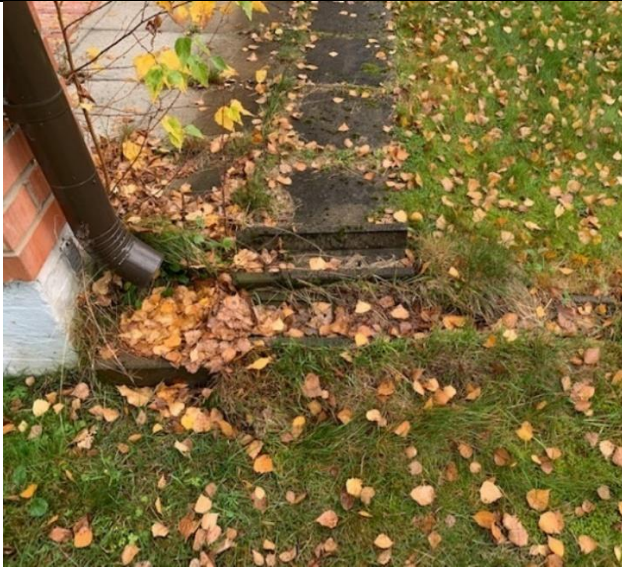
Kuva 40. Sadevesien ohjaus puutteellista M-talon takapihalla (Termonen 2020 CC BY-SA)
