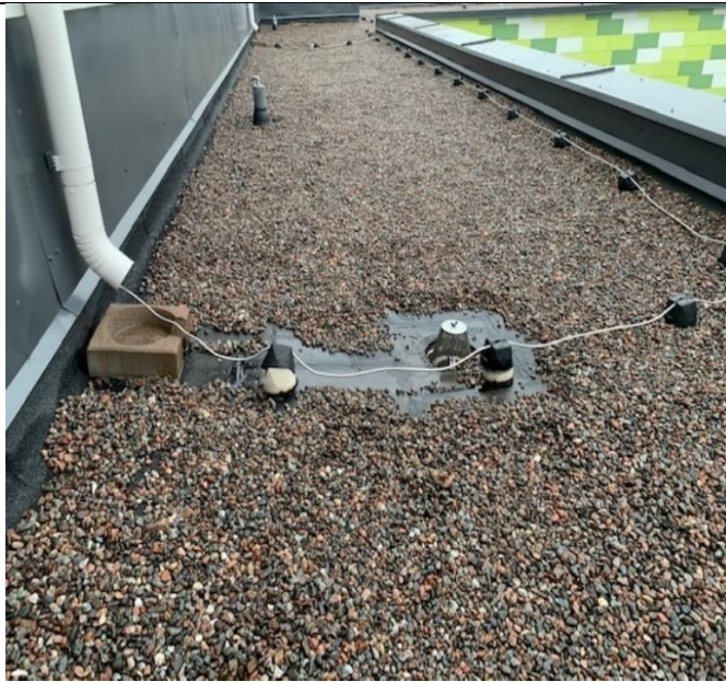
Kuva 55. Sadevesien ohjausta kaivoihin tehostettu loiskekivillä ja kevytsoran siirrolla, kuvassa myös havaittavissa ukkosen johdattimien kiinnityksen pettäminen (Termonen 2020 CC BY-SA)
