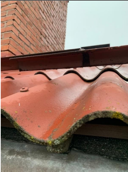
Kuva 80. Katteella havaittu pinnoitteen osittaista pinnoitteen hilseilyä, naulojen tiivisteet kunnossa (Termonen 2020 CC BY-SA)
