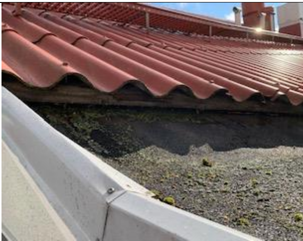
Kuva 12. Alimmissa ruodelaudassa havaittavissa lahoa liitosalueen kohdalla (Termonen 2020 CC BY-SA)
