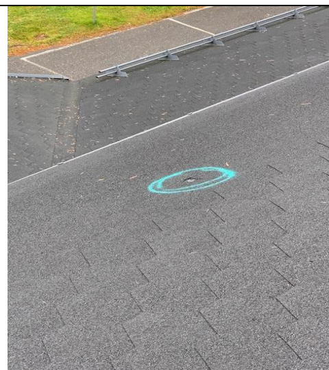
Kuva 4. Havaittu reikä katteessa (Termonen 2020 CC BY-SA)
