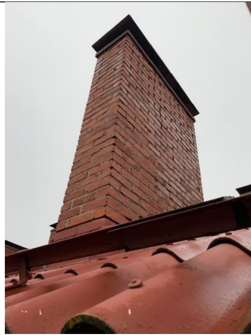
Kuva 83. Piipun pellityksissä ei havaittuja puutteita (Termonen 2020 CC BY-SA)
