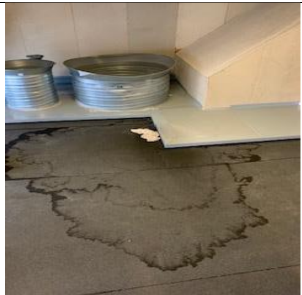
Kuva 4. Läpiviennin vuotokohta tuloilmakammion lattiassa (Termonen 2020 CC BY-SA)
