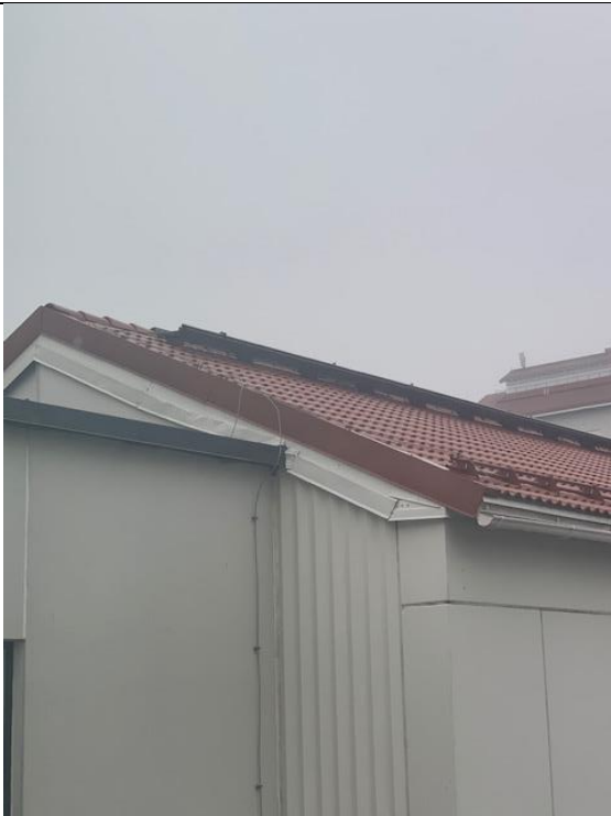
Kuva 30. Reunapellitykset repsottavat G1 ja G2 liitosalueella (Termonen 2020 CC BY-SA)
