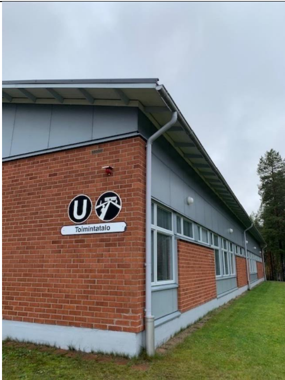
Kuva 57. Sadevedet ohjautuvat suoraan kaivon aiheuttamatta roiskeita perustuksille (Termonen 2020 CC BY-SA)
