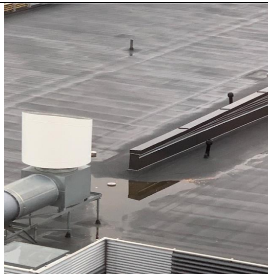
Kuva 73. Katolla havaittu tukkeuma havainnollistamaan vesien kertymistä kaivojen toimimattomuuden vuoksi (Termonen 2020 CC BY-SA)
