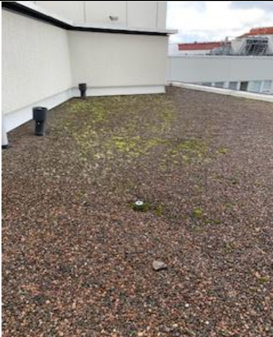
Kuva 40. I-siiven vesikatolla havaittuja sammalkertymiä (Termonen 2020 CC BY-SA)
