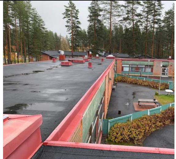
Kuva 16. Katon kallistukset kaivoille päin, mutta vesi seisautuu ajansaatossa painuneisiin monttuihin katolla (Termonen 2020 CC BY-SA)
