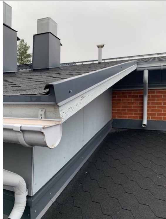
Kuva 58. Räystäissä havaittavissa maalin hilseilyä (Termonen 2020 CC BY-SA)
