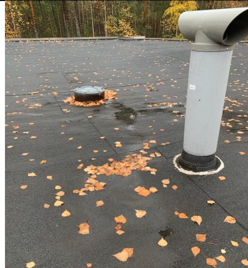
Kuva 36. Kattokaivo tukkeutuneena lehdistä ja läpiviennin lisätiivistys (Termonen 2020 CC BY-SA)
