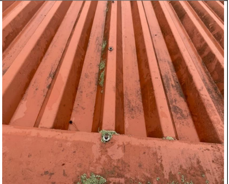
Kuva 68. Sammalkertymää P1-parkkihallin katolla, ruuvien tiivisteet silmämääräisen tarkastelun perusteella kunnossa (Termonen 2020 CC BY-SA)
