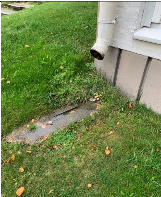
Kuva 87. Sadevesikourujen ohjauksessa havaittu puutteita talon ympärillä (Termonen 2020 CC BY-SA)
