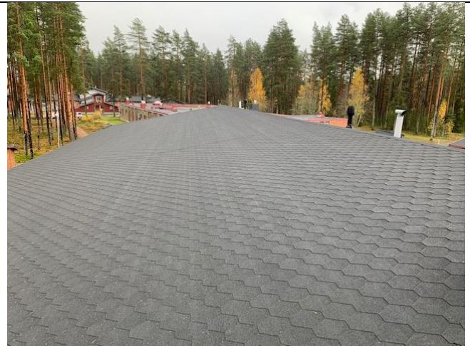
Kuva 31. Pitkien ja matalien lappeiden tuuletusta lisättiin kattopohjassa kesällä 2020 asentamalla poistoilmapuhaltimet (Termonen 2020 CC BY-SA)
