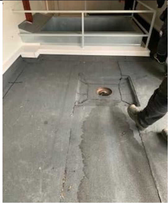
Kuva 9. Vesikattokaivo ullakkotilassa (Termonen 2020 CC BY-SA)
