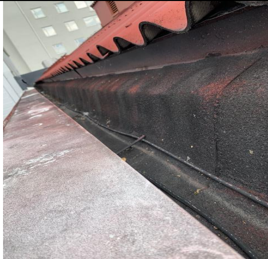
Kuva 20. Sadevesikourujen ja pellityksien pinttymää (Termonen 2020 CC BY-SA)
