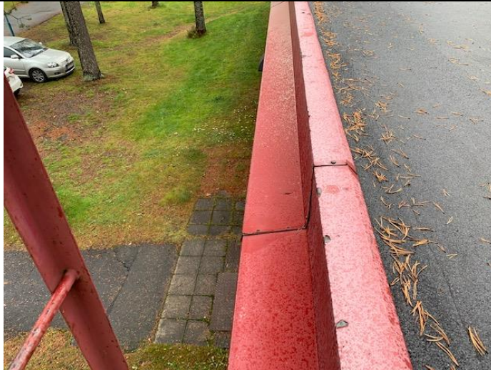
Kuva 15. Reunapellityksien kiinnityksessä havaittu nauhojen puuttumista (Termonen 2020 CC BY-SA)
