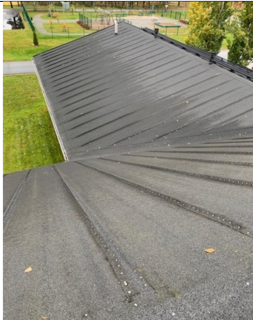
Kuva 50. Huopakaton kiinnityksessä puutteita, nauhaus kolmiorimaan osittain huonosti kiinni (Termonen 2020 CC BY-SA)
