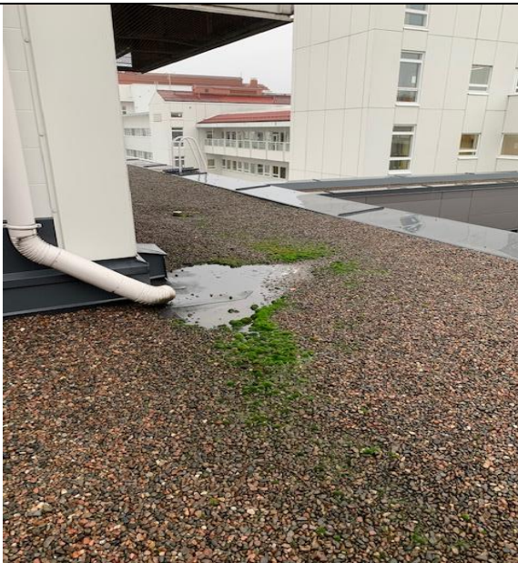
Kuva 32. Vesikaton sammalkertymä ja sadevesien ohjauksen puutteita (Termonen 2020 CC BY-SA)
