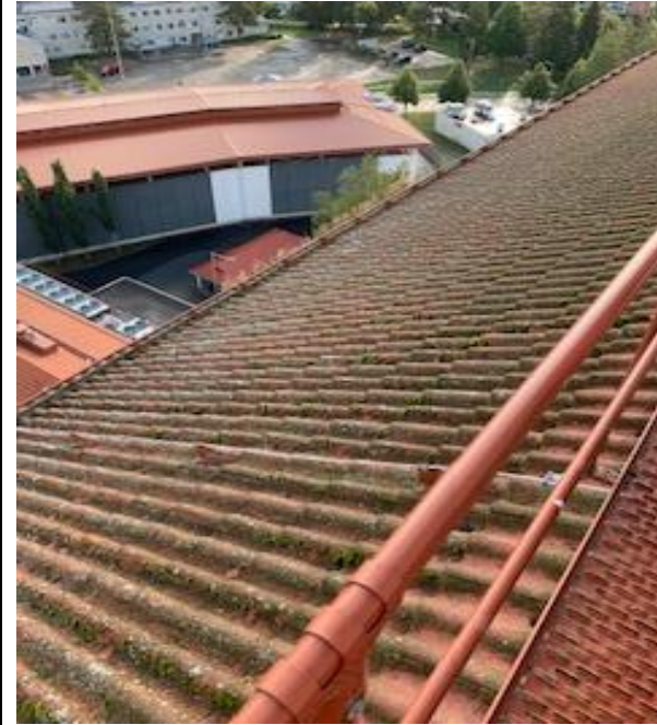
Kuva 2. Vesikaton sammalkertymää (Termonen 2020 CC BY-SA)
