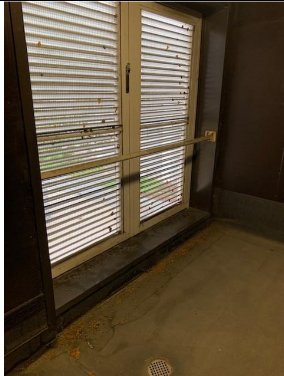
Kuva 86. Tuloilmakammion sisäpuolella huopakattorakenne ja kaadot kairoon päin (Termonen 2020 CC BY-SA)
